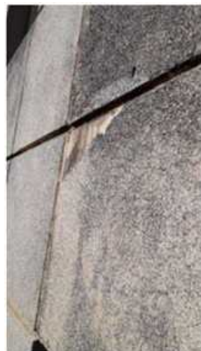
Figura 22 - Desprendimento na Fachada Edifício Aliança
