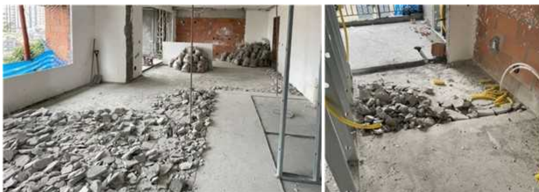
Figura 16 – Quebra de contrapiso com manifestações patológicas por som cavo
