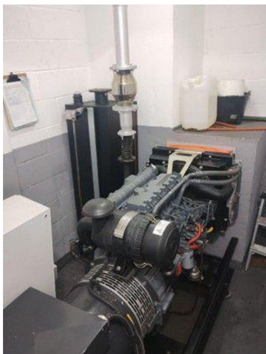
Figura 18 — Espaço do abrigo para gerador: iluminação
