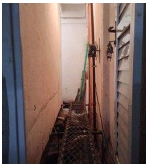
Figura 24 — Vista interna da passarela de circulação para acesso aos registros de extravasão e limpeza
