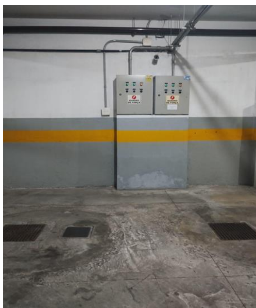
Figura 15 — 2º subsolo do Edifício “A” - QLFs de bombas e tampas dos poços de esgoto
