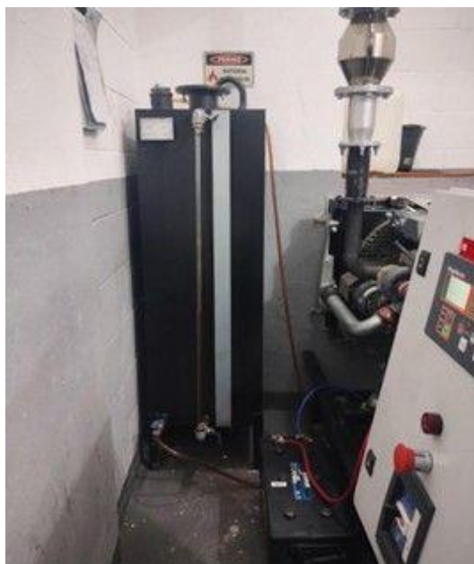
Figura 19 — Espaço do abrigo para gerador: tanque de combustível
