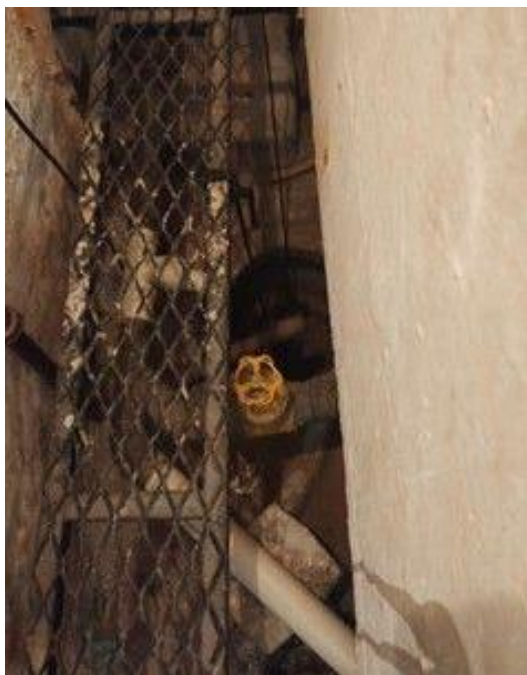
Figura 21 — Passarelas metálicas e tubulações nas laterais do reservatório de água potável
