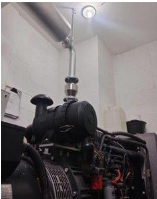
Figura 17 — Espaço do abrigo para gerador: iluminação
