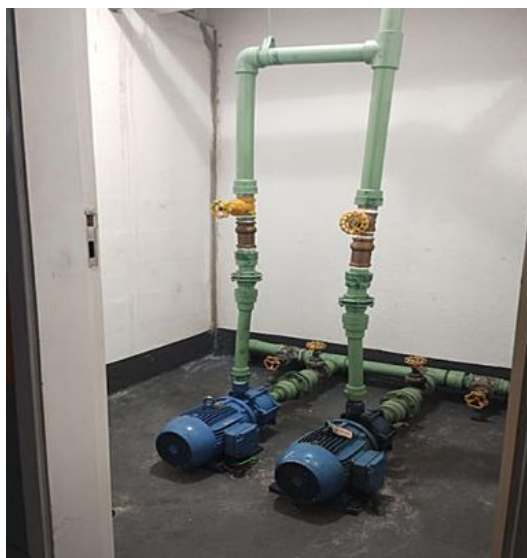
Figura 23 — Vista interna da casa de bombas
