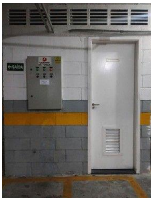
Figura 22 — Vista externa da casa de bombas, QLF e ventilações
