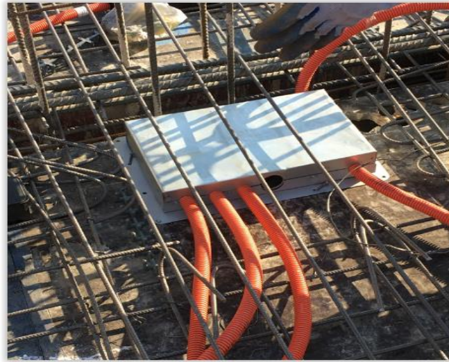
Figura 17 – Caixa central para quadro elétrico
