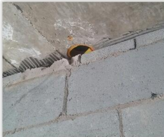
Figura 18 – Caixa de passagem em distribuição na alvenaria
