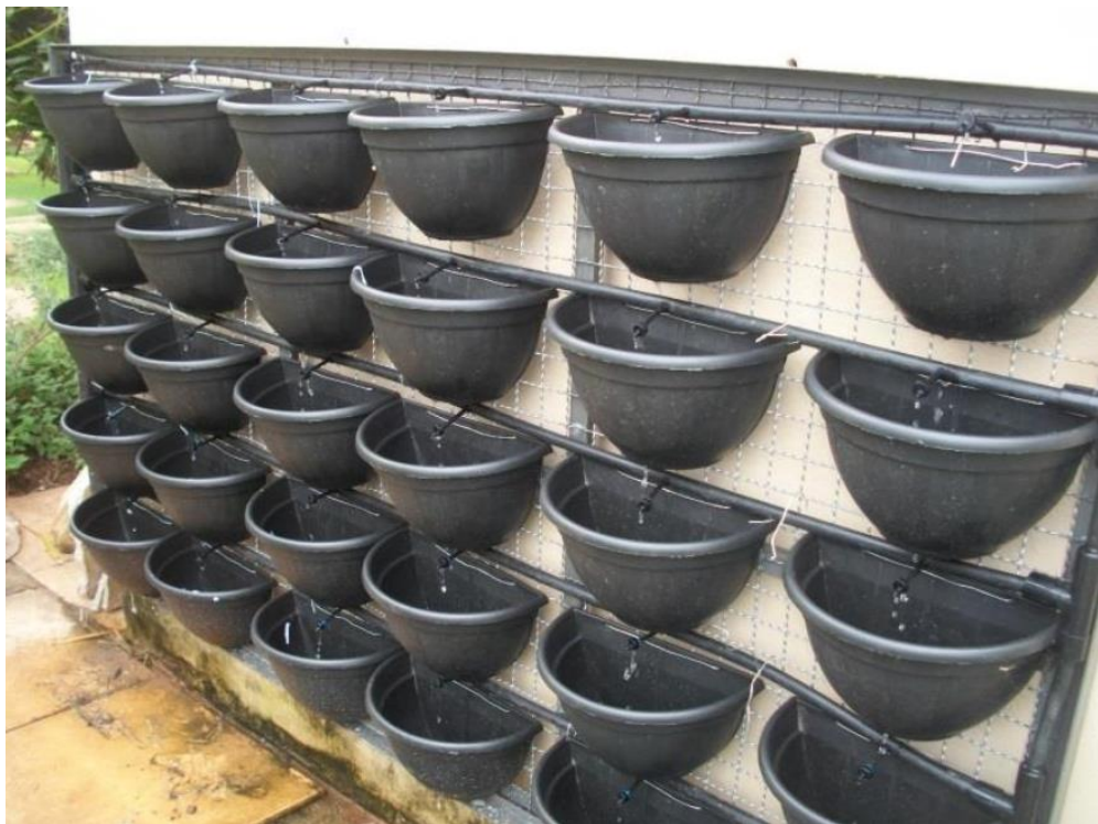
Figura 8 - Sistema de irrigação de jardim vertical por gotejamento
