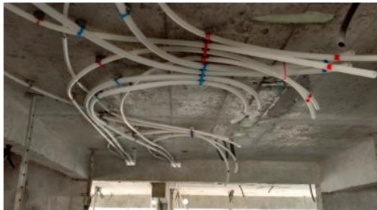
Figura 4 - Distribuição aérea do kit hidráulico fixado com abraçadeiras e perfil metálico, identificados
