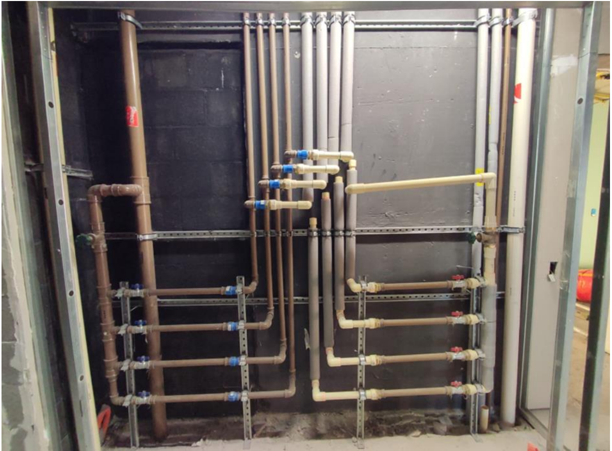
Figura 9 - Distribuição de alimentação do pavimento com pentes pré-montados para shaft central (HGI)
