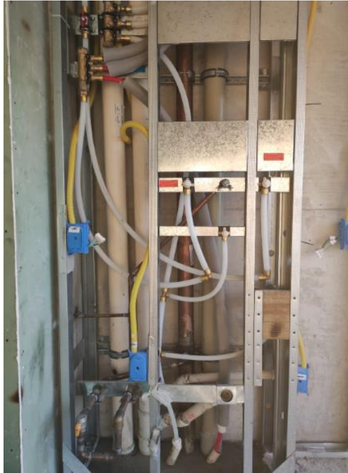
Figura 6 - Shaft com chassi de esgoto com estrutura em aço galvanizado leve, pré-fabricada
