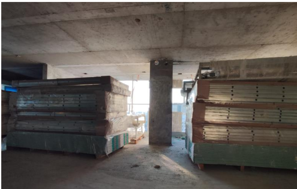
Figura 21 - Armazenamento de módulos Smart Wall sobre placas de gesso acartonado no pavimento destino
