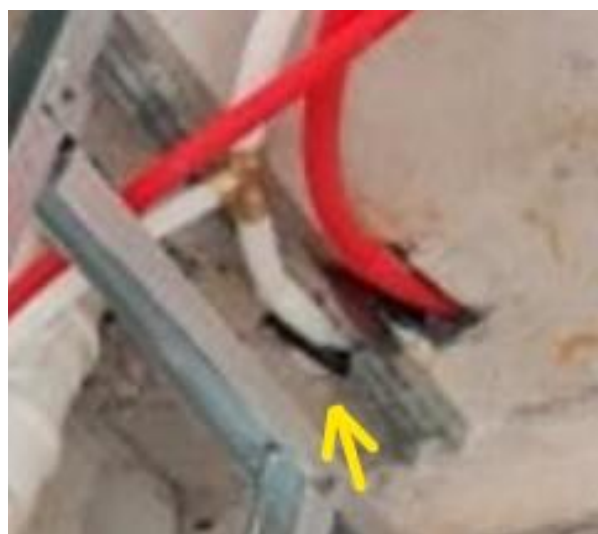
Figura 92: Perfil superior para drywall recortado.
