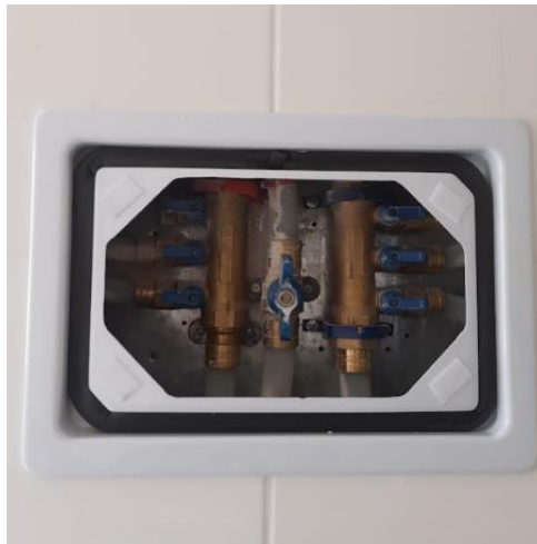
Figura 50: Caixa de inspeção para registro manifold.
