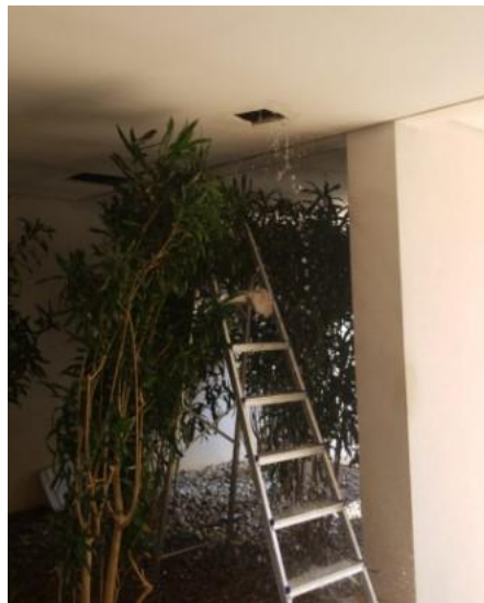
Figura 7: Vazamento sobre forro de entrada social.
