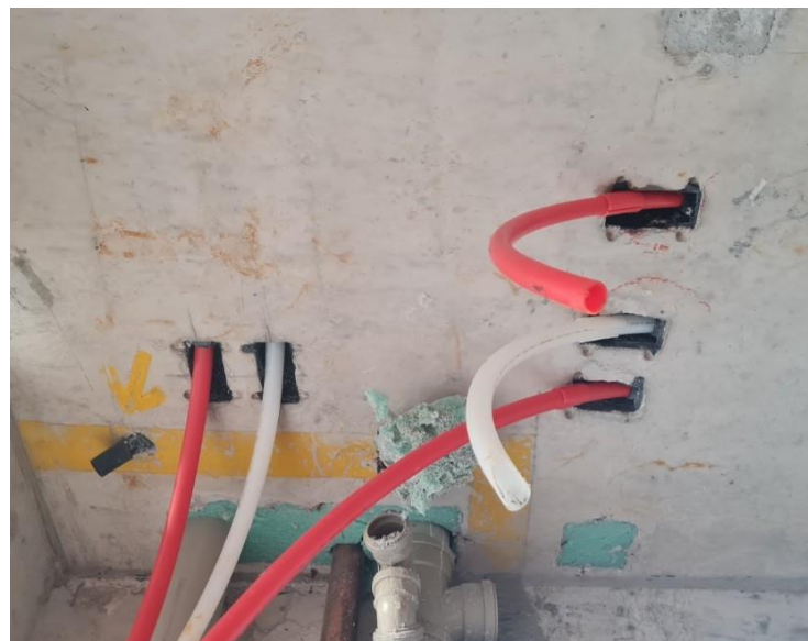
Figura 39: Ramal em PEX embutido.
