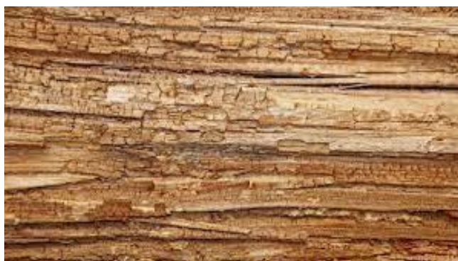
Figura 5- Madeira prejudicada pelo acúmulo de água
