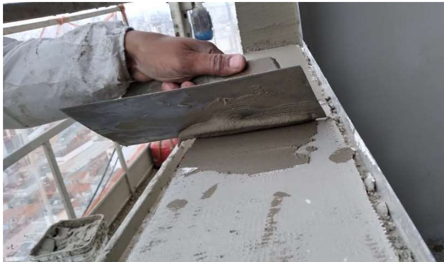
Figura 34 - Camada de argamassa para caimento que será revestida com chapa de alumínio
