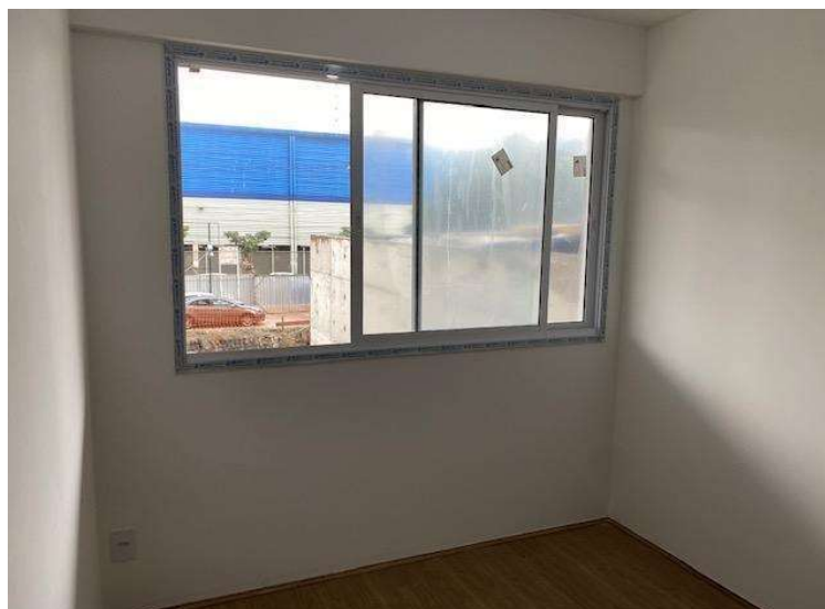
Figura 41 - Unidade finalizada e vista da saliência da viga de borda sobre a esquadria
