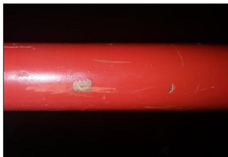
Figura 3.37 – Tubulação com furos
