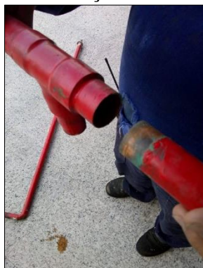
Figura 3.34 – Falha em soldagem de tubulação da Odontologia
