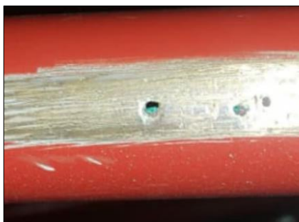
Figura 3.36 – Tubulação com furos
