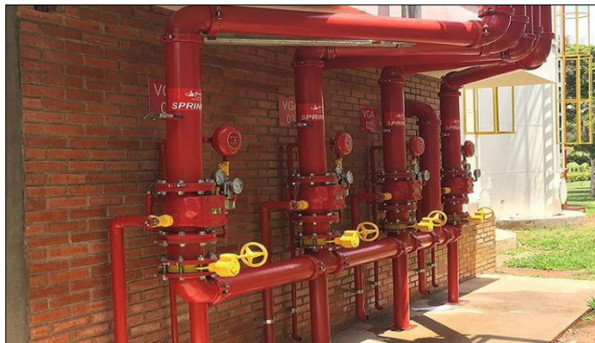
Figura 2.10 – Válvula de governo e alarme (VGA) do sistema de chuveiros automáticos.
