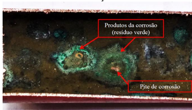
Figura 3.44 - Tubo de cobre, parede interna, apresentando pites e produtos de corrosão de coloração esverdeado.
