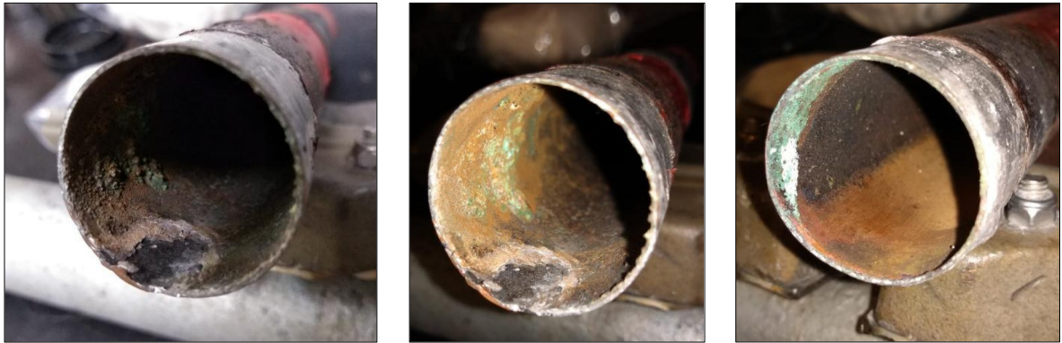
Figura 3.42 – Tubos com resíduos de corrosão
