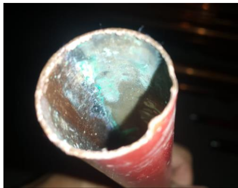
Figura 3.41 – Tubulação com resíduos de corrosão
