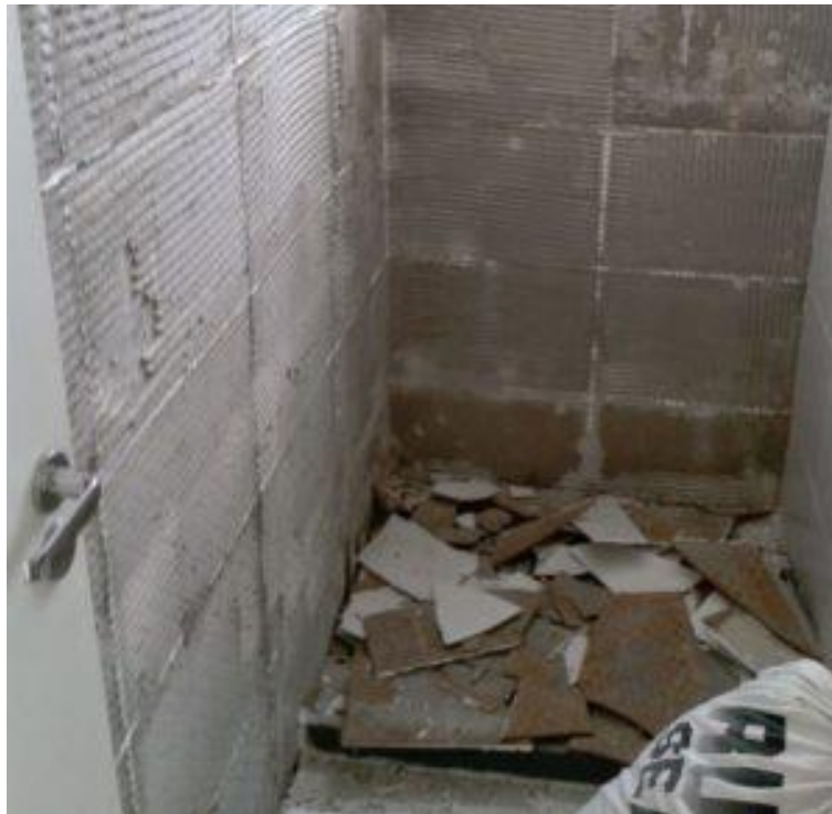
Figura 14 - Exemplo de deslocamento do revestimento cerâmico
