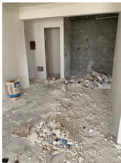
Figura 64 – Acúmulo de resíduos de gesso após a execução do revestimento
