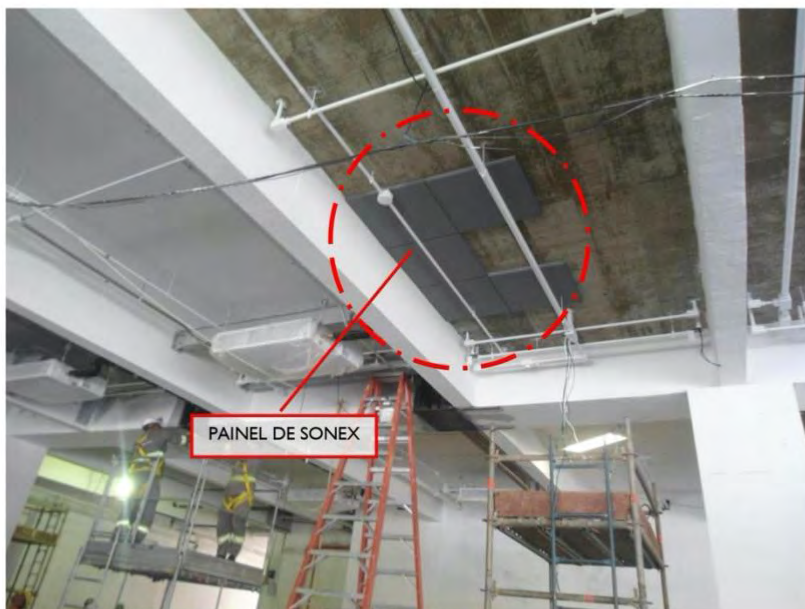
INSTALAÇÕES NO FORRO (PAVIMENTO TÉRREO)
