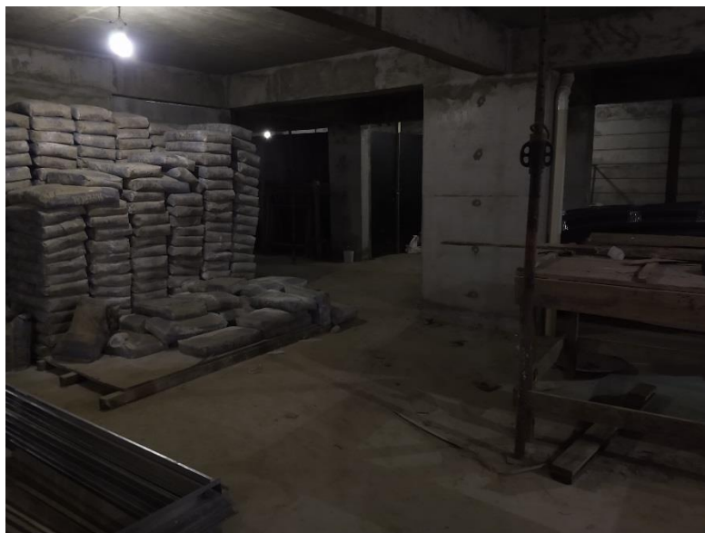
Figura 31 - Armazenamento de cal no 2º subsolo
