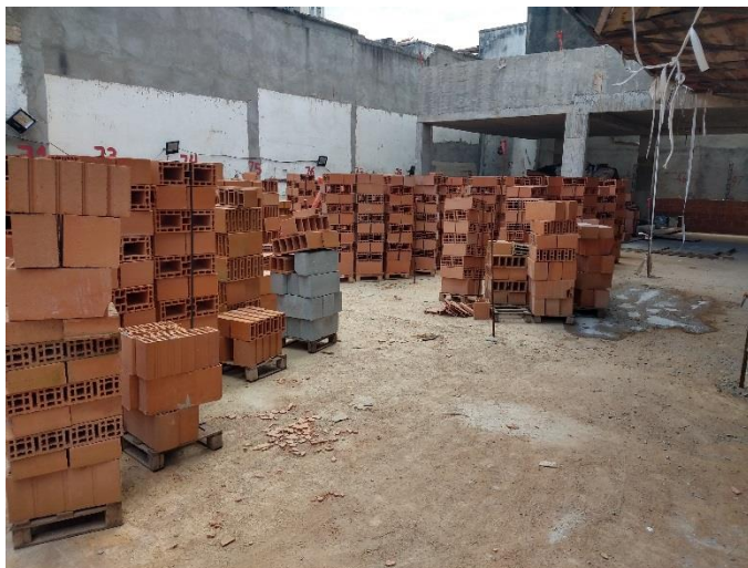
Figura 29 - Armazenamento de blocos na área externa do canteiro
