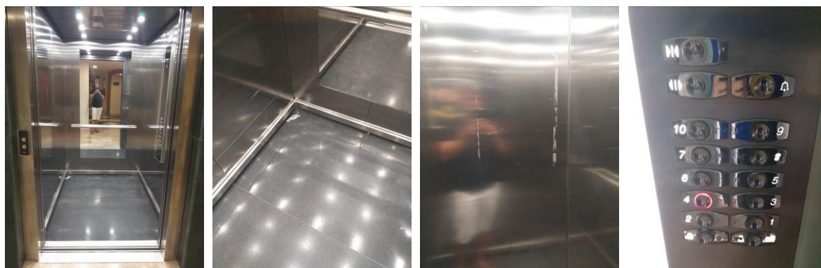
Figura 17. Conservação e manutenção dos elevadores
