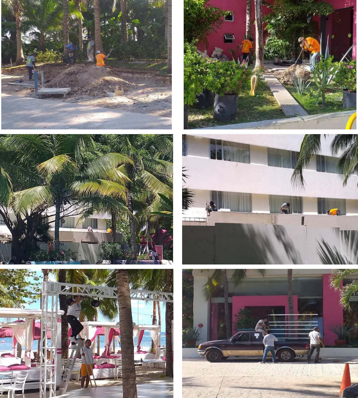
Figura 15. Funcionários sem EPI's em situação de risco
