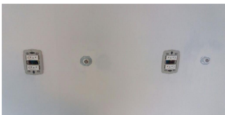
TOMADAS ELETRICAS / OUTLETS
