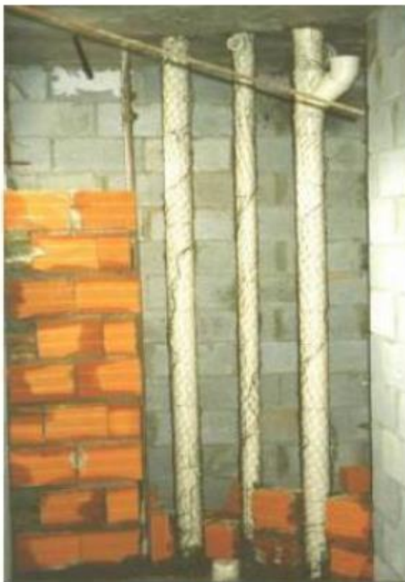
Figura 37 - Escoamento da tubulação fora da parede
