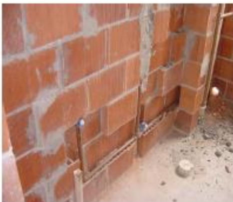
Figura 15 - Rasgo em paredes devido à passagem de tubulação
