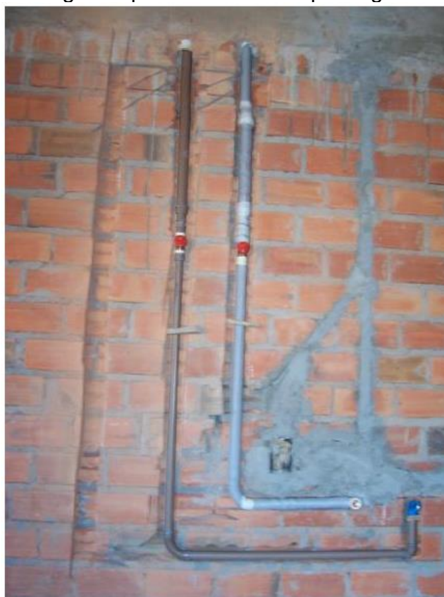
Figura 14 - Rasgo em paredes devido à passagem de tubulação
