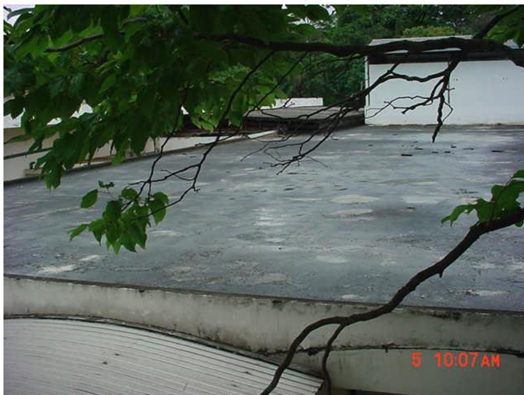
Figura 35 - Situação da cobertura em laje plana existente do Bloco B do Conjunto Alessandro Volta do IF (Fonte: SEF)
