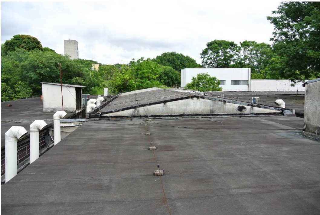
Figura 54 - Cobertura existente com impermeabilização de acabamento ardosiado no Edifício Principal do Instituto Oceanográfico (Fonte: SEF)
