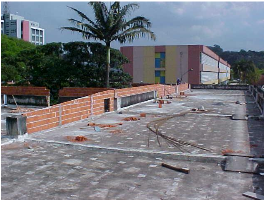
Figura 29 - Obra de instalação do telhado sobre a laje sem as placas de sombreamento do Bloco A da ECA (Fonte: SEF)
