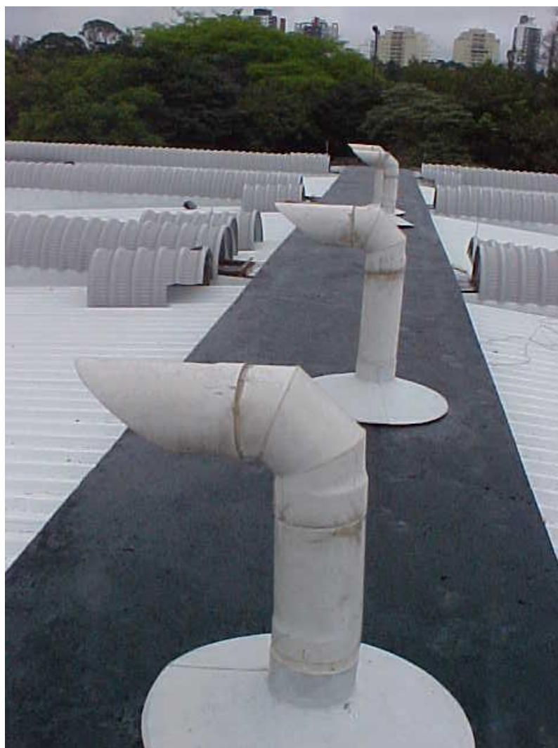
Figura 63 - Tubulações redirecionadas para a laje de cobertura do “shaft” dos Blocos 13, 15 e 17 da FCF (Fonte: SEF)
