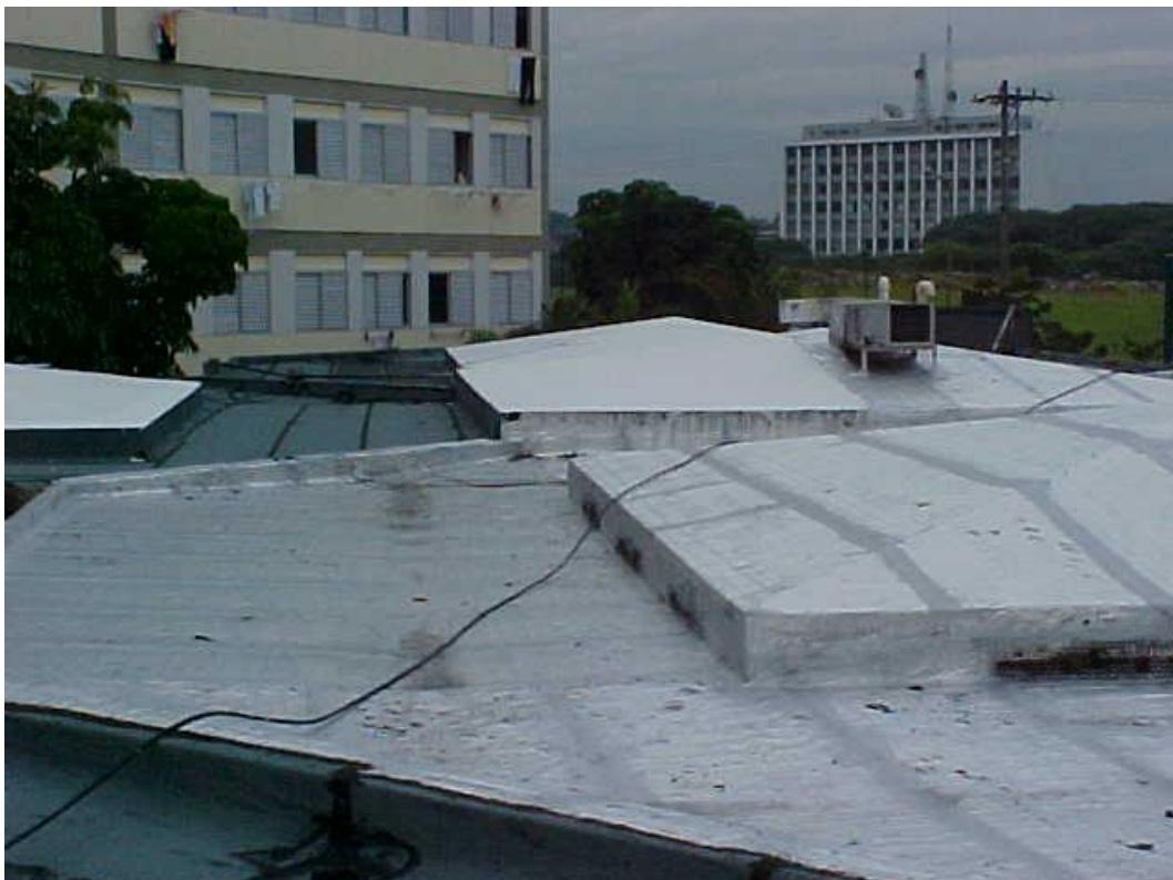
Figura 47 - Laje existente com camada de impermeabilização no Conjunto das Colméias– antes da intervenção (Fonte: SEF)
