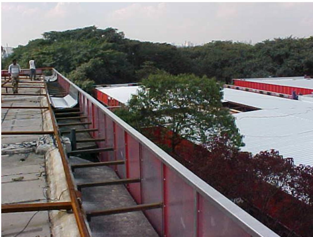
Figura 45 - Instalação da platibanda e calha na cobertura dos Blocos do Departamento de Ciências Sociais da FFLCH (Fonte: SEF)
