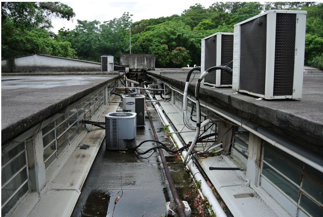
Figura 56 - Laje rebaixada onde se concentra os equipamentos de apoio do edifício principal do IO (Fonte: SEF)
