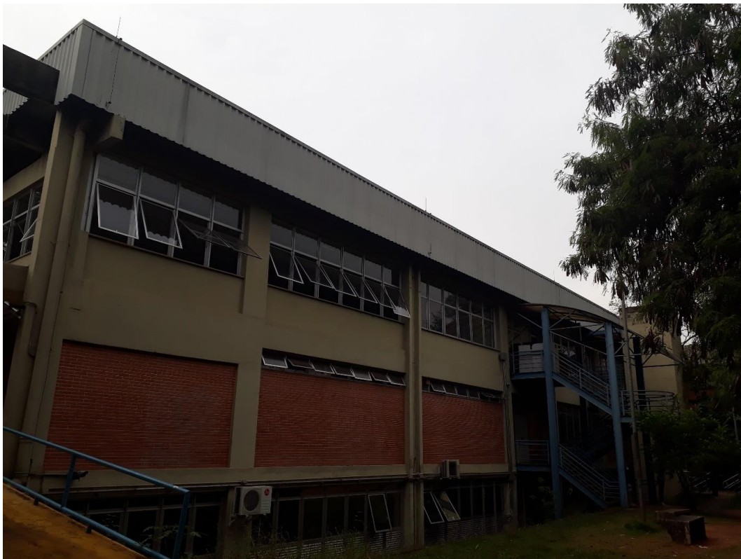
Figura 13 - Vista geral do edifício e a platibanda da cobertura do Centro de Vivências do Conjunto das Químicas (Fonte: SEF)
