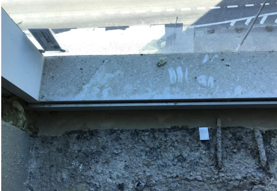
Figura 43 – Selo corta fogo instalado ( fire stop )
