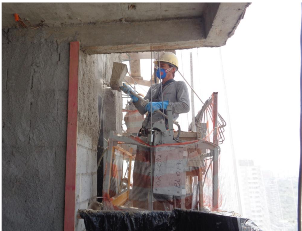
Figura 33 – Operário executando o revestimento da fachada com argamassa projetada (Fonte: Documentos internos Tibério Construções e Incorporações S.A., 2018)
