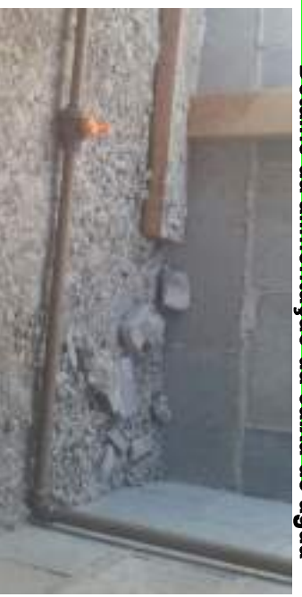
Detalhe da alimentação da caixa de água
