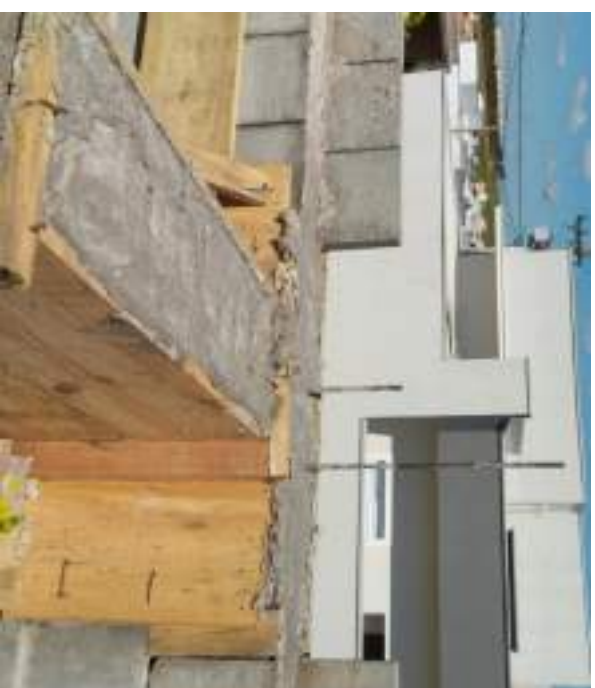
Detalhe do engaste da Viga VL na Canaleta J da Parede P07
