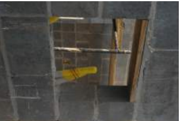
Detalhe do QD da Parede P16
