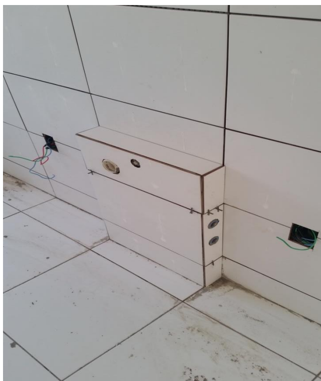
Foto 21 - Instalações da máquina de lavar prato, esgoto e pia
