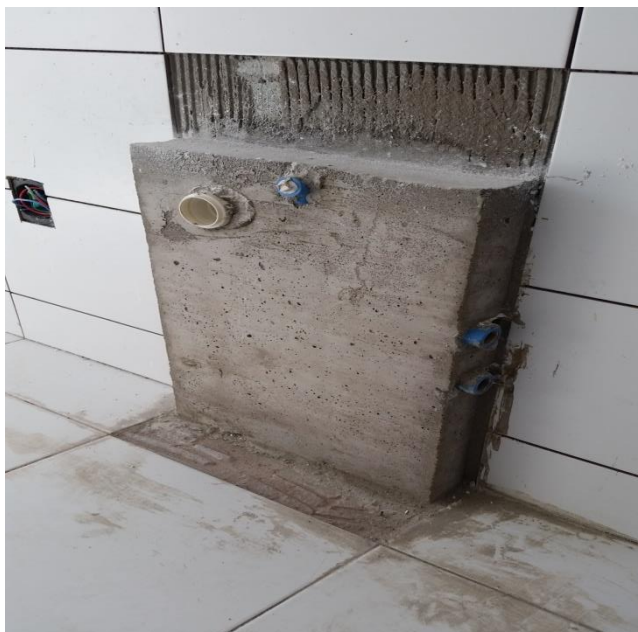
Foto 20 - Instalações da máquina de lavar prato, esgoto e pia
