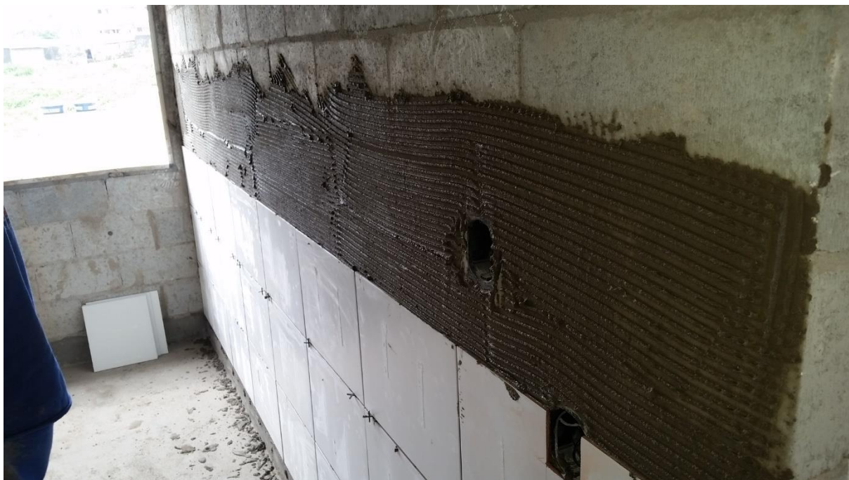
Foto 23 - Incompatibilidade da caixa elétrica x cerâmica direto no bloco
