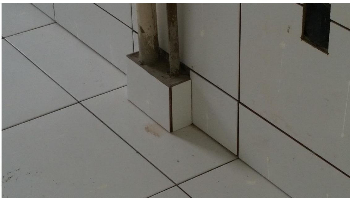
Foto 19 - Instalações máquina de lavar prato e esgoto pia
