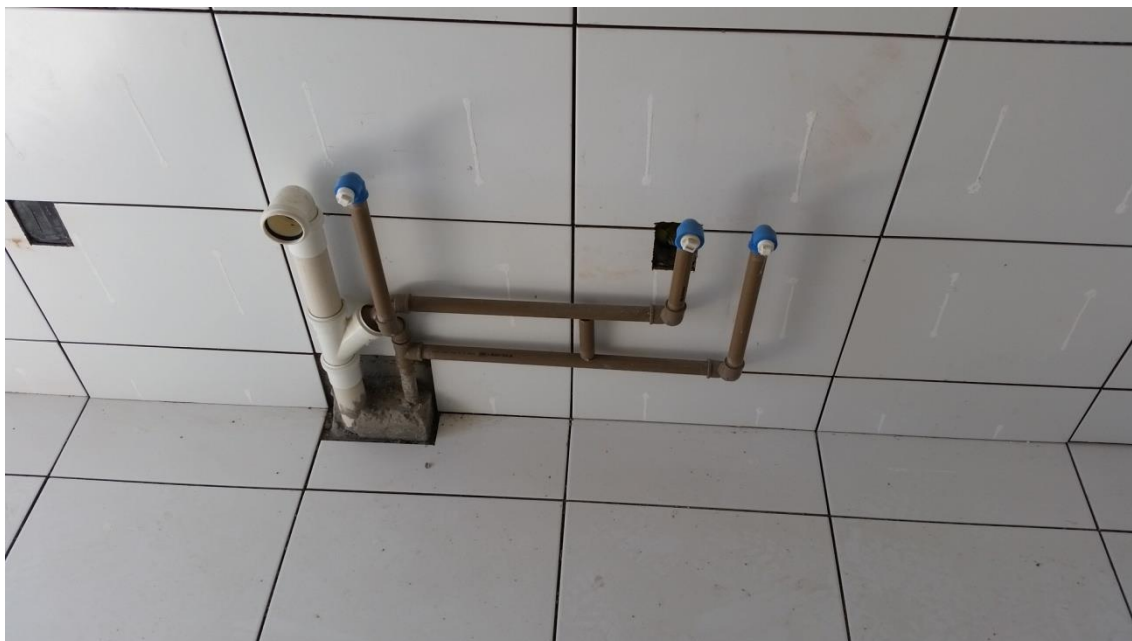
Foto 18 - Instalações máquina de lavar prato e esgoto pia
