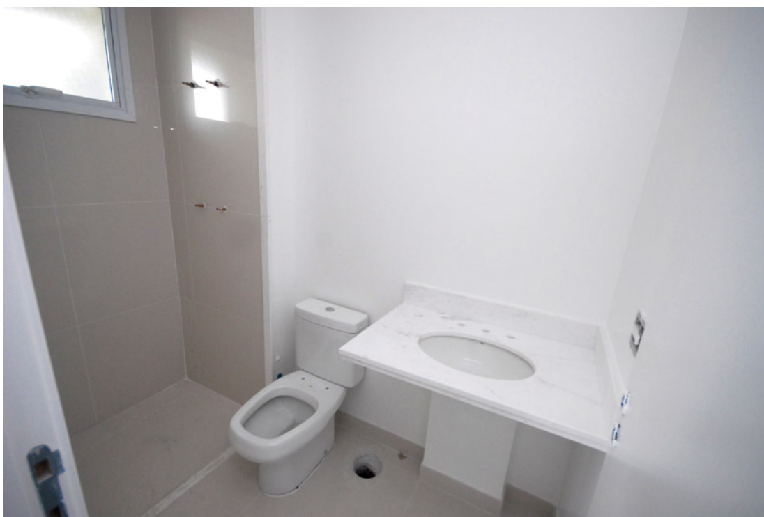
Figura 42–Banho Social – Material Padrão – Empreendimento Padrão B
