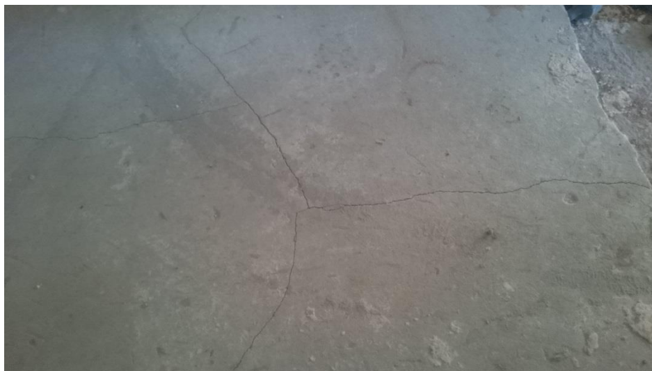
Figura 28 – Fissura profunda no contrapiso
