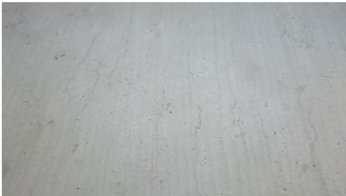
Figura 29 – Fissuras superficiais no contrapiso
