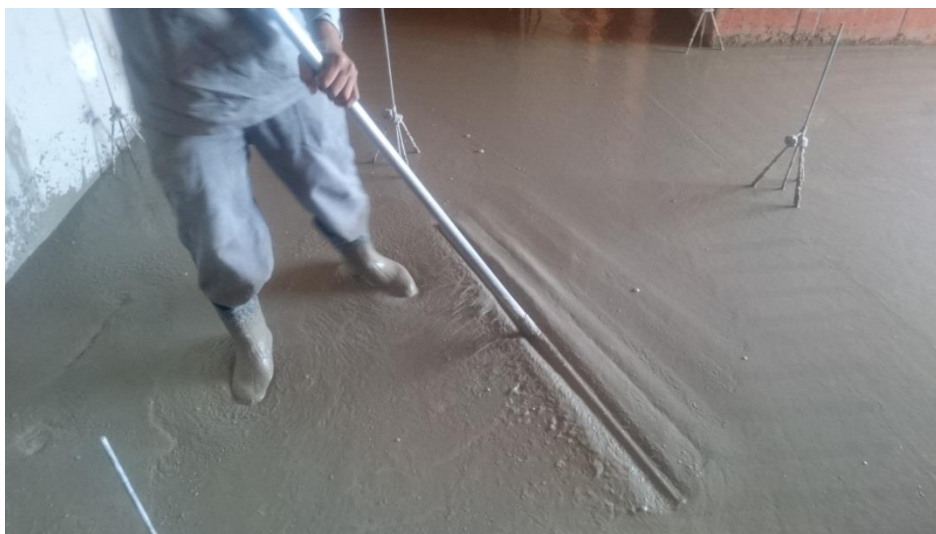
Figura 27 – Acabamento do contrapiso que causa rugosidades/ondulações
