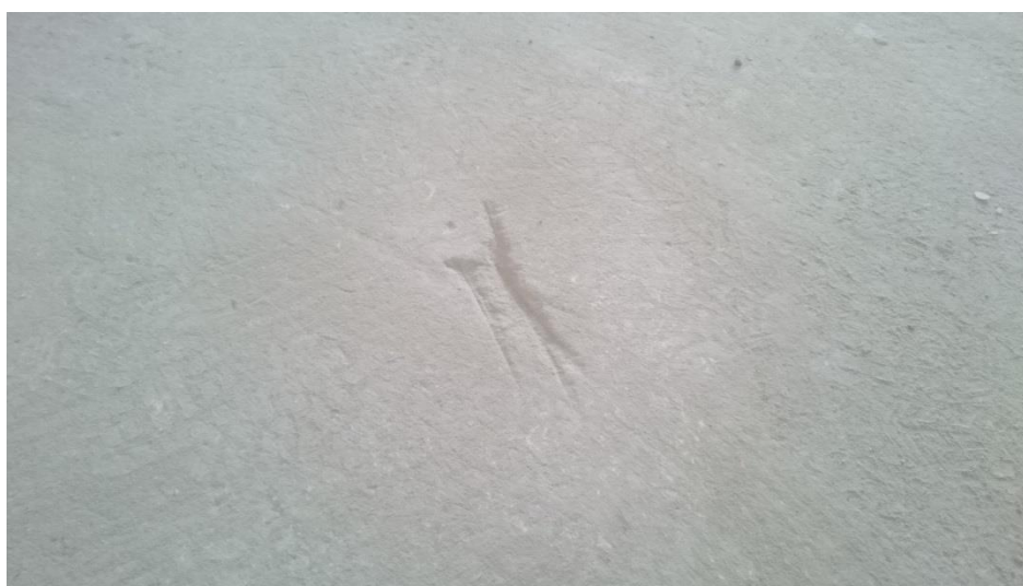
Figura 32 – Falhas no contrapiso
