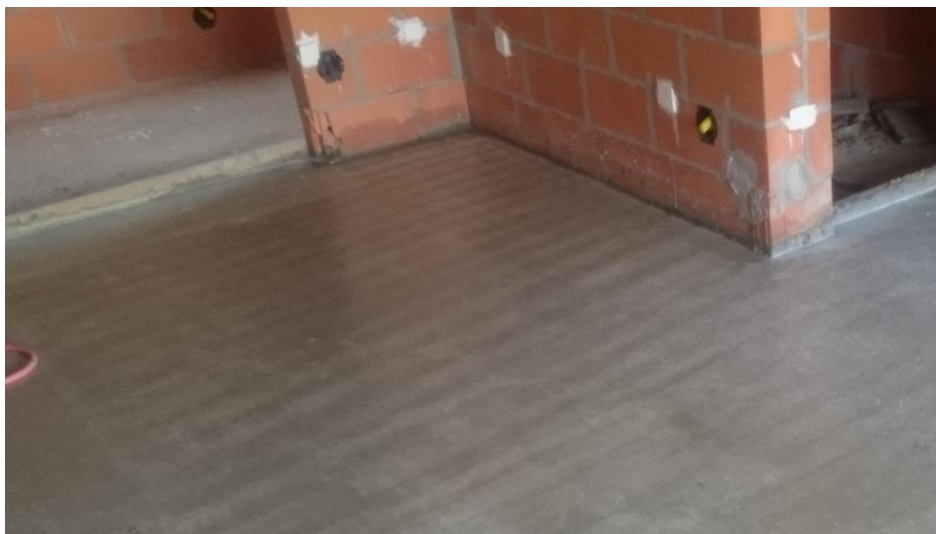
Figura 26 – Rugosidade no contrapiso
