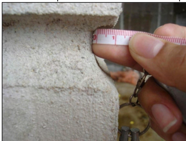
Foto 5 – Junta com profundidade em desacordo com projeto.
