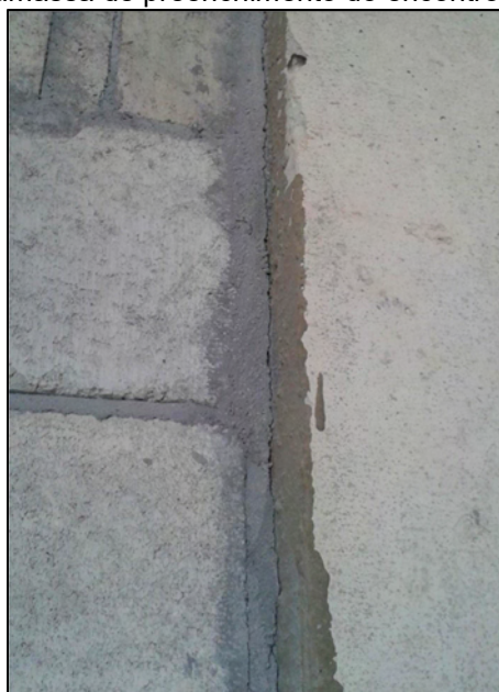
Foto 7 – Fissura na argamassa de preenchimento do encontro da alvenaria com o pilar.
