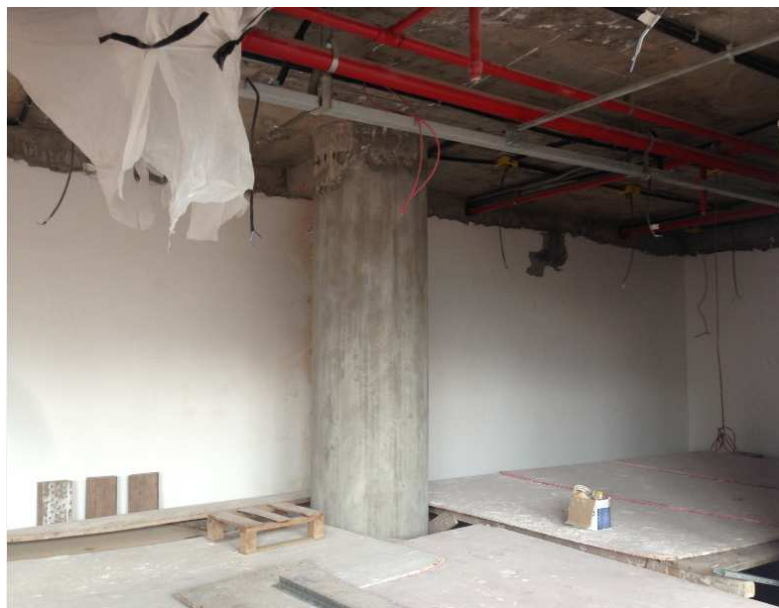
Figura 19: Parede do restaurante sem os pontos executados Fonte: Acervo da empresa (2016)
