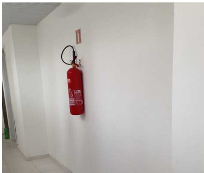
Figura 23: Extintor posicionado na circulação Fonte: Acervo da empresa (2016)
