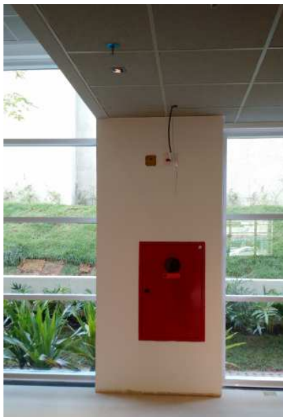
Figura 56: Hidrante na parede do restaurante Fonte: Acervo da empresa (2016)
