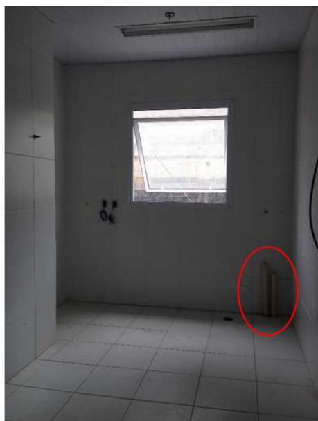
Figura 31: Instalações hidráulicas aparentes no refeitório Fonte: Acervo da empresa (2016)
