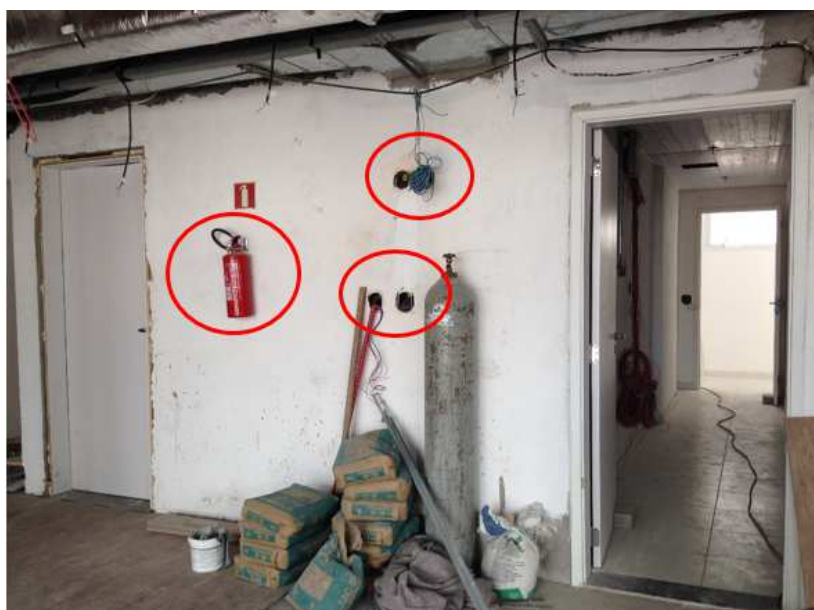
Figura 37: Instalações na parede da recepção Fonte: Acervo da empresa (2016)
