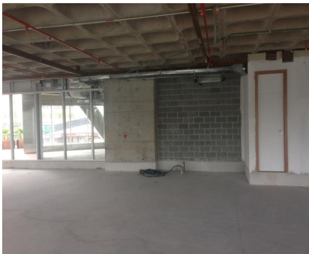
Figura 11 - Situação do imóvel antes da obra
