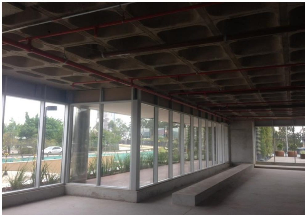
Figura 12 - Situação do imóvel antes da obra
