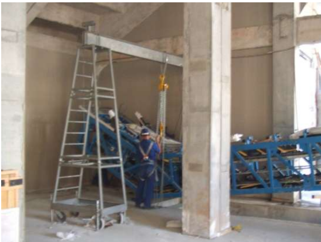
Figuras 22 e 23 – MF: Imagens da 2ª Fase de Obras – Instalação das Escadas Rolantes
