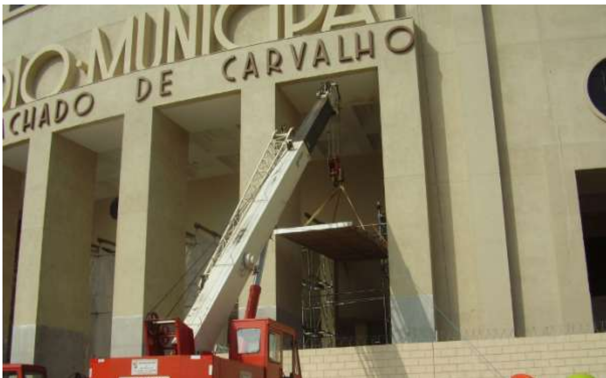
Figuras 64 e 65 – MF: Imagens da 2ª Fase de Obras – Montagem da Passarela
