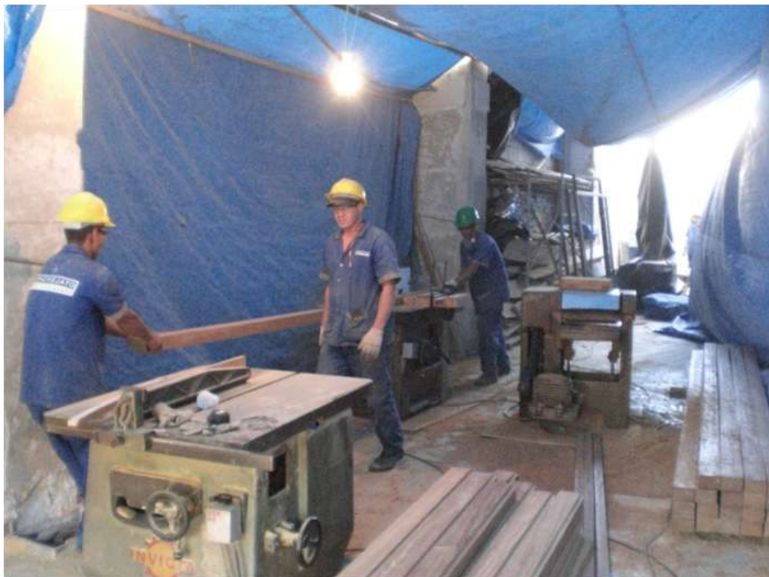
Figuras 66 e 67–MF: Imagens da 2ª Fase de Obras – Carpintaria de Obra
