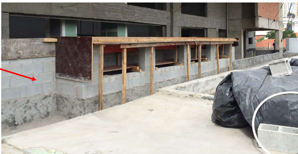
Figura 50 – Foto: Obra com alvenaria solicitada
