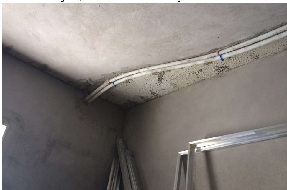
Figura 34 – Foto: desvio das tubulações na estrutura
