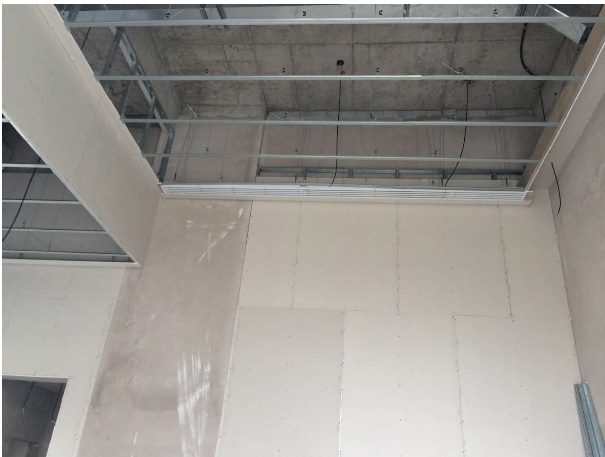
Figura 47 – Foto: Grelha do ar condicionado no desnível do forro
