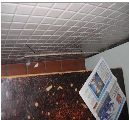
FOTO Nº 22 - 3 - Abertura no revestimento cerâmico da parede - infiltração acentuada com risco à segurança dos usuários devida à cabine elétrica (sala contígua) sujeita à empoçamentos.
