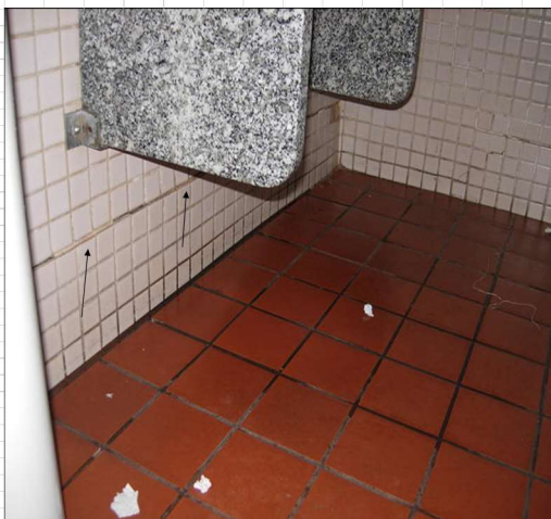
FOTO Nº 22 - 2 - Detalhe de revestimento cerâmico. Infiltração acentuada pela abertura entre juntas do azulejo.
