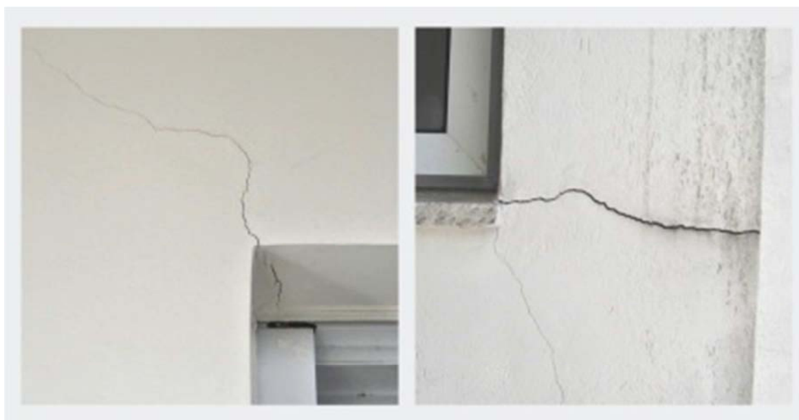
Figura 15: Fissuras tipo 'bigode'
