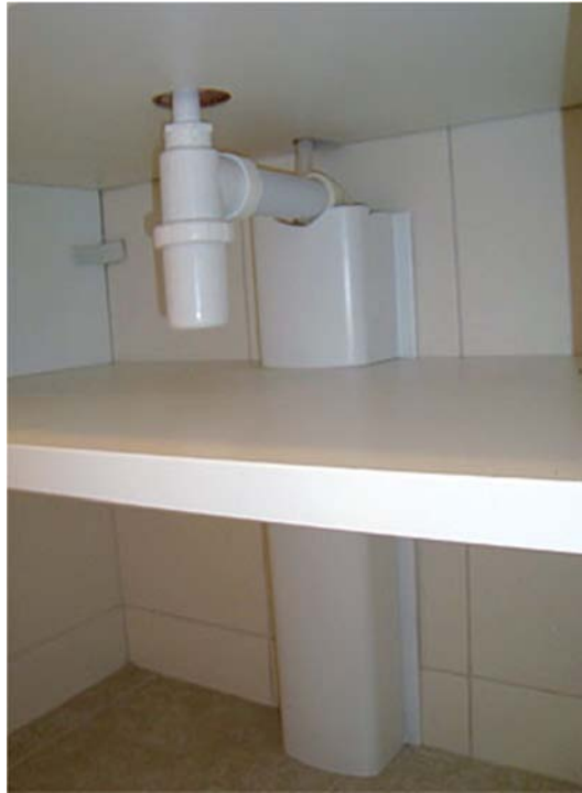
Figura 26: Carenagem plástica ocultando instalação sob pia
