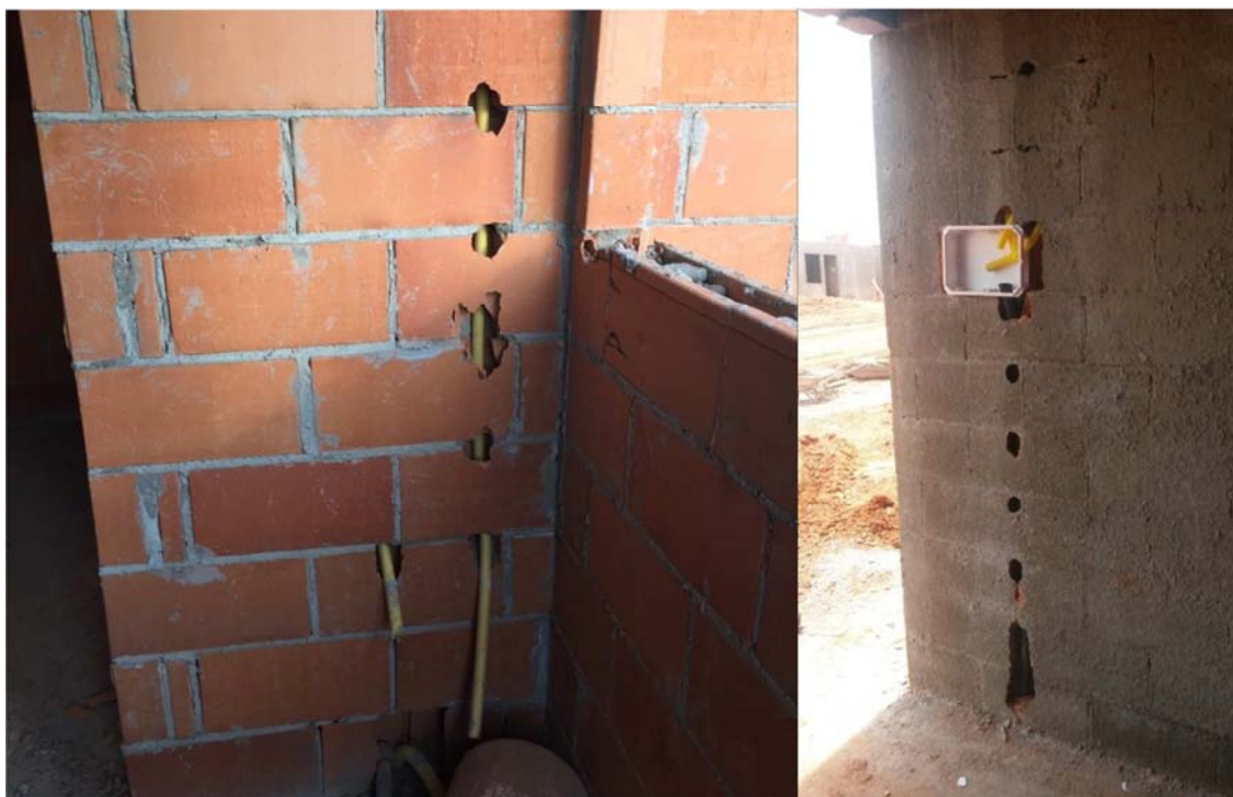
Figura 34: Quebra da alvenaria para passagem de eletroduto em etapa posterior à programada
