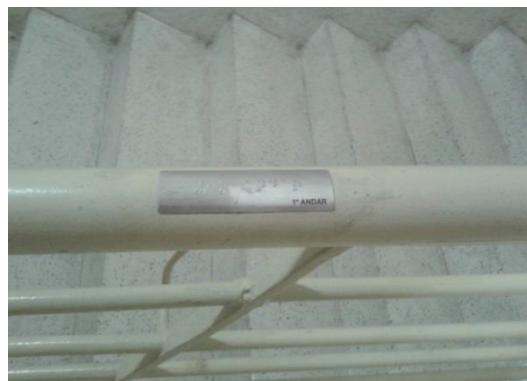
Foto 8 - Celas em braille para instalação no início e término dos corrimãos, com indicação do local a ser acessado.
