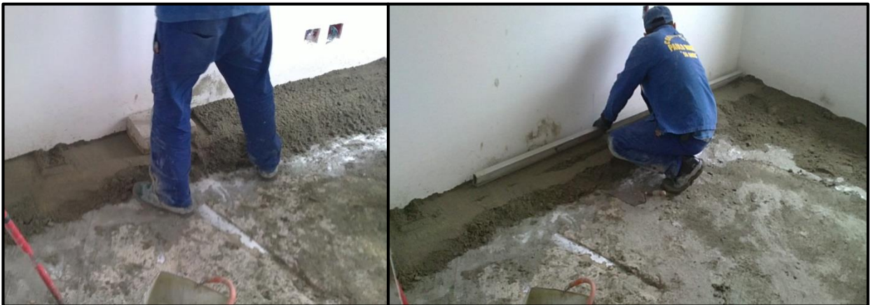
Figura 12: A foto à esquerda ilustra a compactação do contrapiso com um peso de madeira. A foto à direita ilustra o sarrafeamento do contrapiso com uso de uma régua de alumínio.
