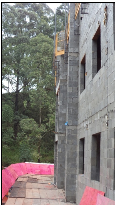
Figura 21 - Foto da parede com ressalto na fachada
