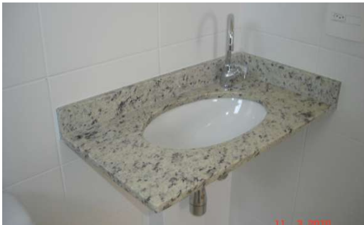
Figura 20 - Foto da bancada com a torneira instalada na diagonal por falta de espaço
