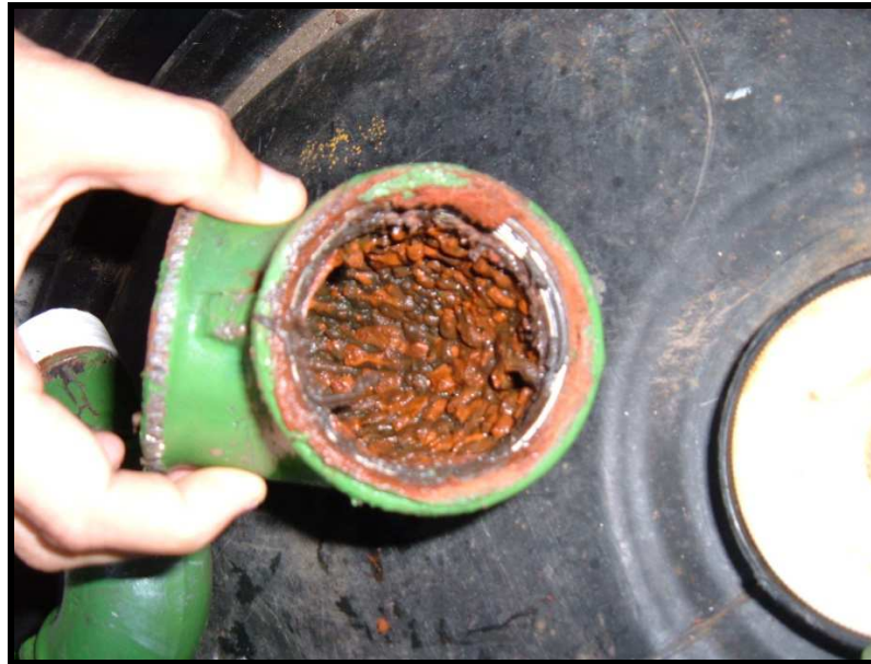
Figura 5 – Incrustação em Tubulação
