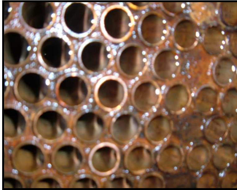
Figura 2 – Corrosão espelho de um trocador de calor
