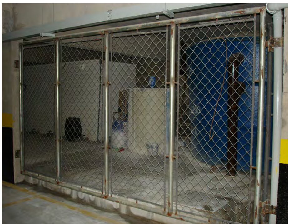
Figura 23. Estação de tratamento das águas cinzas do empreendimento localizada no 2º subsolo. (Foto da autora)
