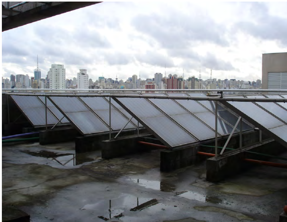
Figura 19. Placas Coletoras dispostas na laje de cobertura do edifício. (Foto da autora)
