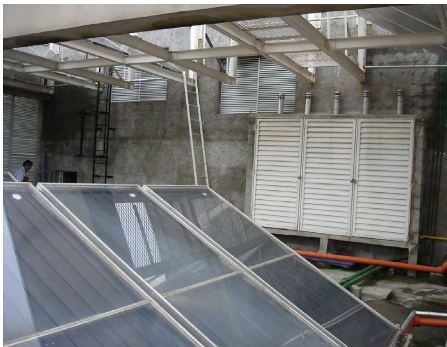
Figura 20. Placas Coletoras dispostas na laje de cobertura do edifício e ao fundo o armário com os aquecedores do sistema de aquecimento a gás conjugado. (Foto da autora)
