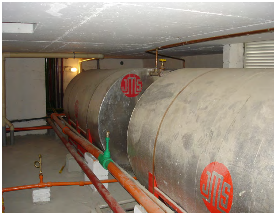
Figura 21. Tanques de acumulação de água quente. (Foto da autora)
