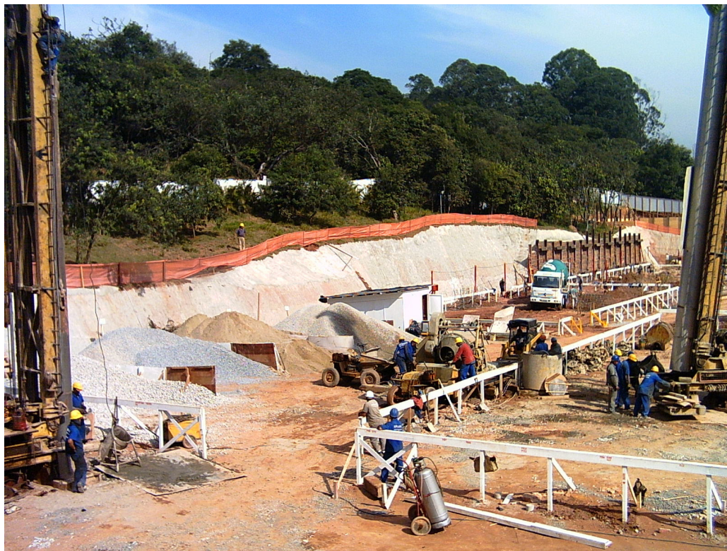
Figura 3.8 – Vista parcial do canteiro, com dois equipamentos de estaca Franki e, ao fundo, caminhão de concreto concretando um tubulão.
