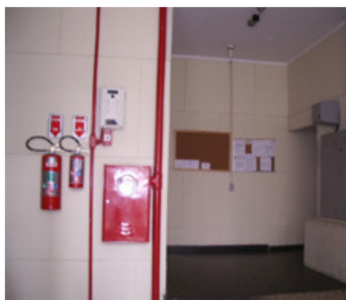
Figura 18 – Equipamentos de Proteção e Combate a Incêndios
