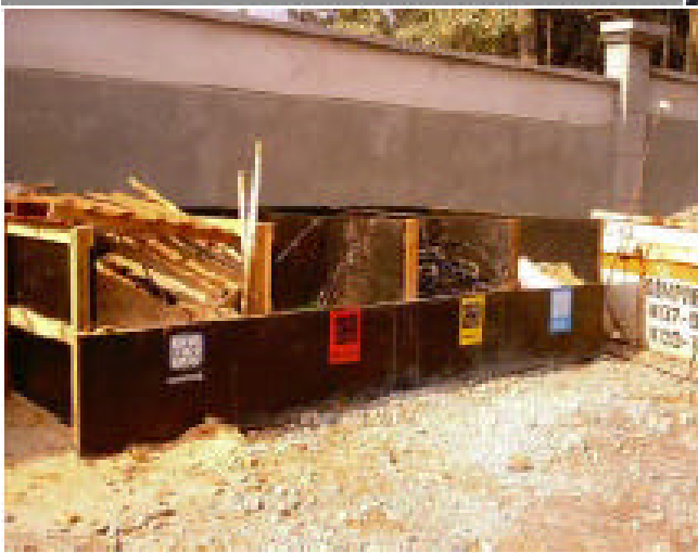
Figura 4.3 – Baias para acomodação de madeira, aço, vidro e plástico.
