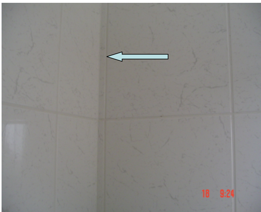
Figura 4.1 – Falta de modulação entre a parede e a placa cerâmica.
