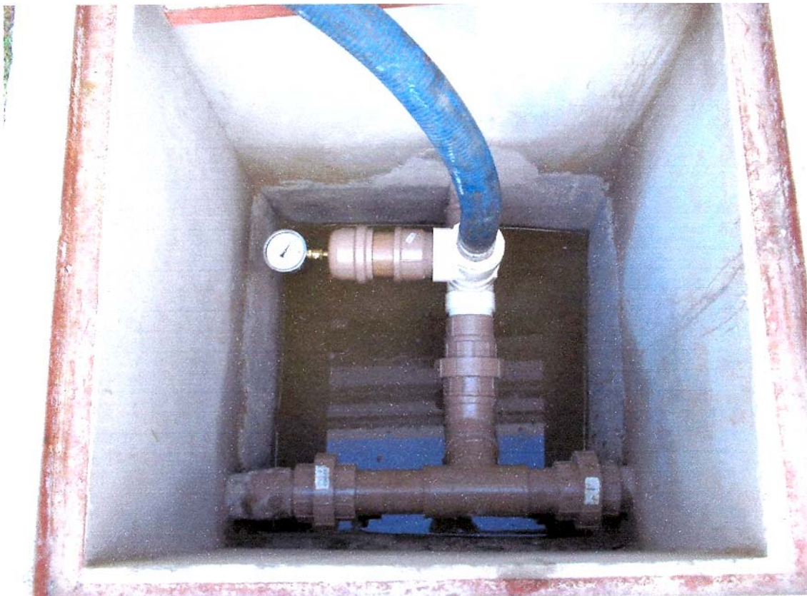
Ilustração 6-17 - Caixa de passagem em alvenaria. (Foto: Guedes B. P.)
