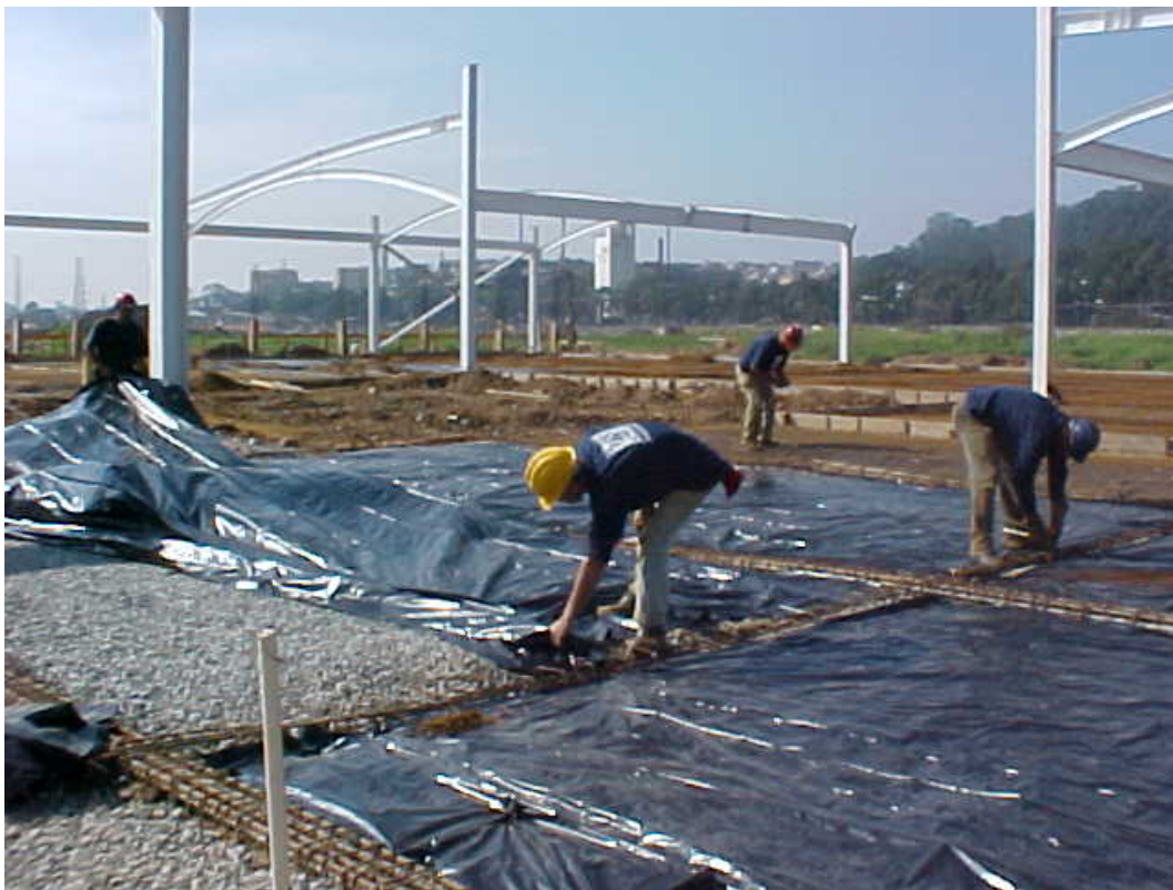
Ilustração 6-15 - Detalhe da proteção do dreno sob a laje armada. (Foto: Joaquin E. F. A. Oviedo)
