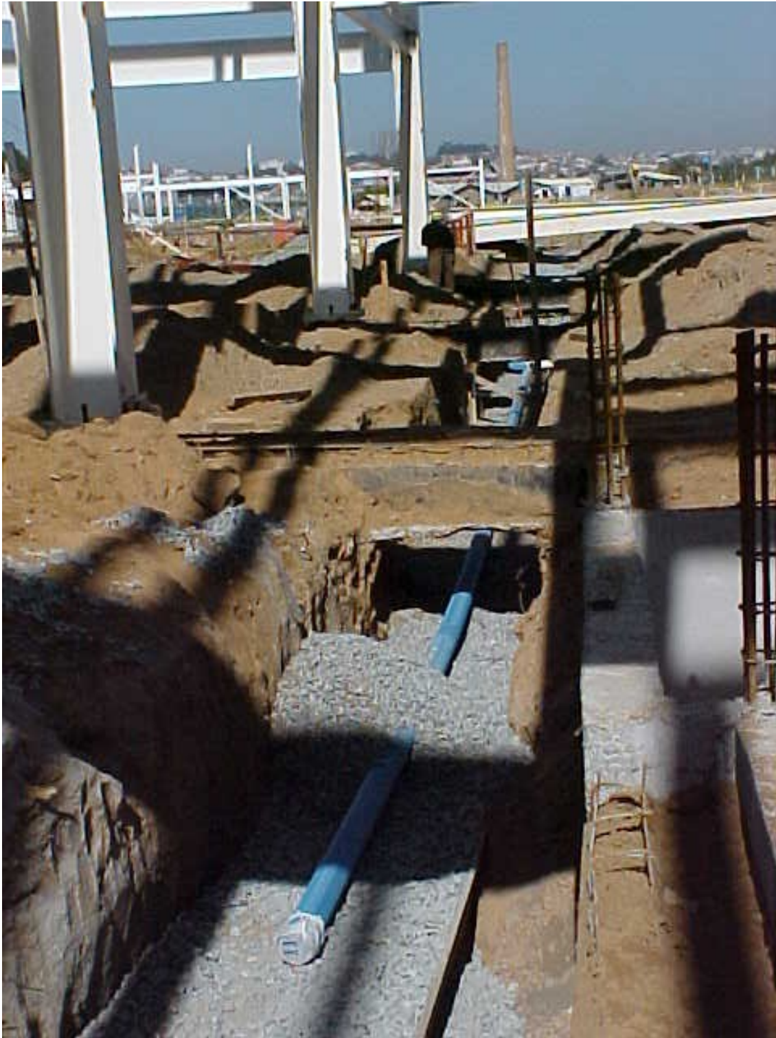
Ilustração 6-4 - Detalhe do preenchimento das trincheiras com pedra brita n.º 2. (Foto: Joaquin E. F. A. Oviedo)
