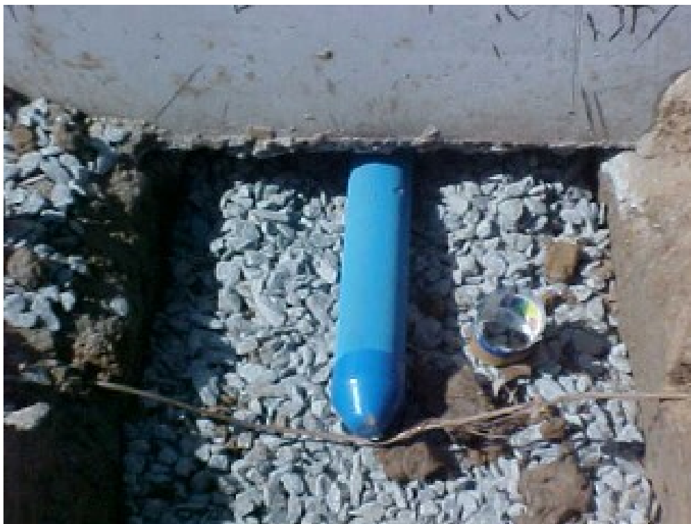
Ilustração 6-12 - Detalhe de interferência dos drenos com o sistema de aterramento. (Foto: Joaquin E. F. A. Oviedo)
