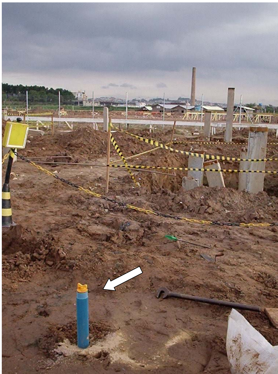
Ilustração 4-11 - Poço de monitoramento instalado conforme recomendações da NBR. (Foto: Guedes B. P)
