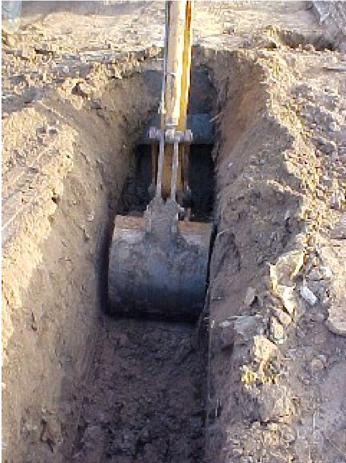
Ilustração 6-1 - Escavação de trincheiras para instalação de drenos de gás. (Foto: Joaquin E. F. A. Oviedo)
