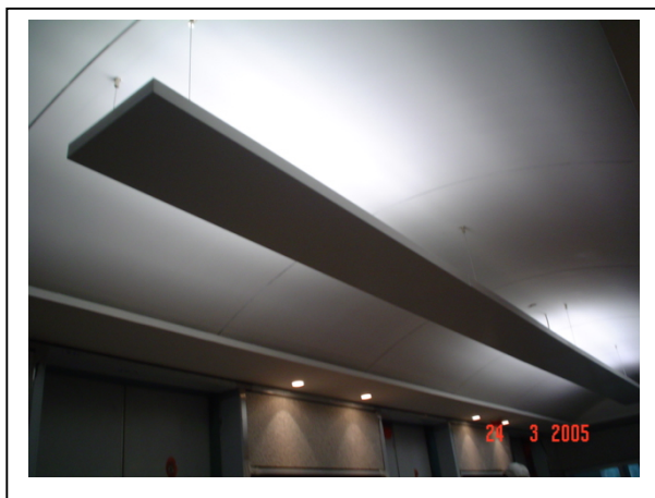
Figura 38 – Luminária Principal Instalada
