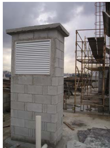
Shaft ventilação e hidráulico
