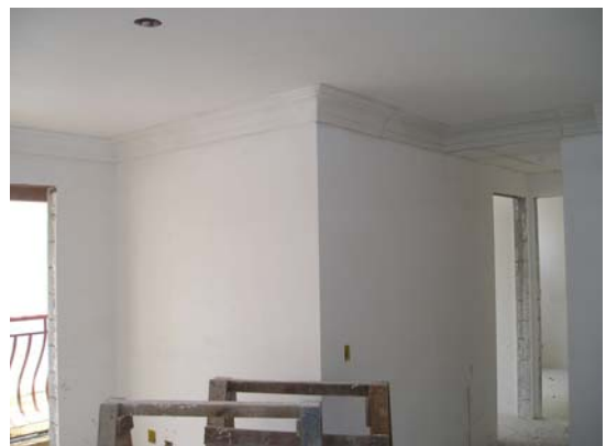
Tubulação embutida na moldura de gesso
