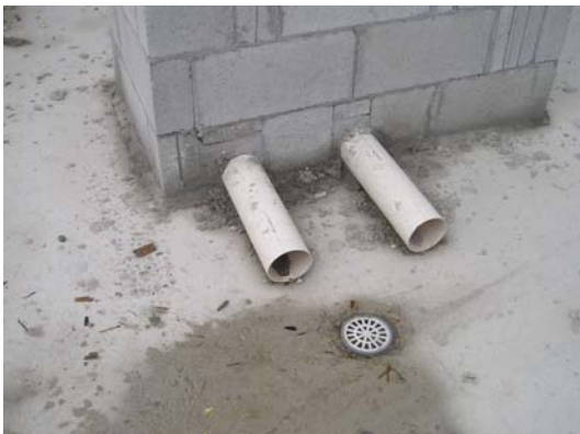
Ralo de segurança na laje de Cobertura
