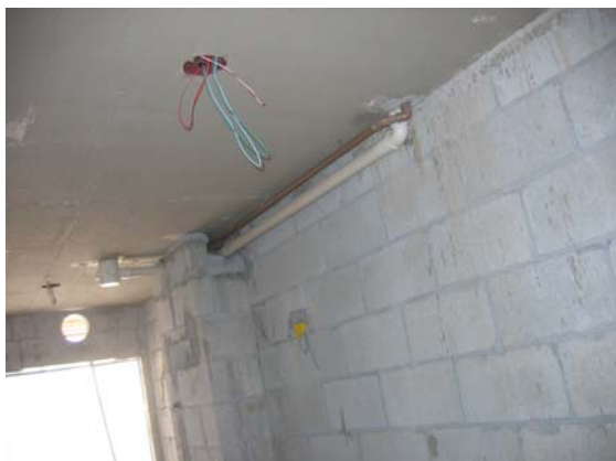
Tubulação esgoto e água fria pia cozinha
