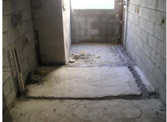
Pontos aquecedor, gás e água quente
