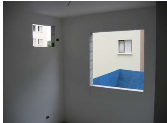
Previsão ar condicionado na suíte
