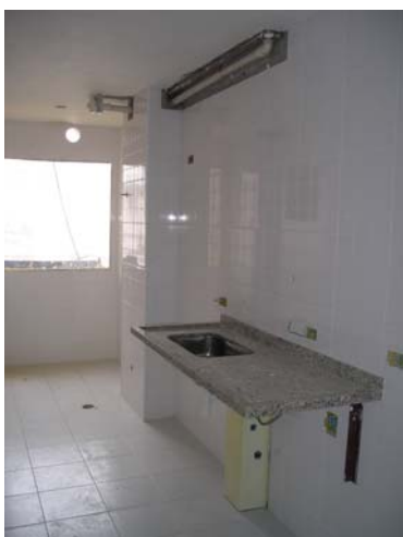
Ponto de esgoto da pia
