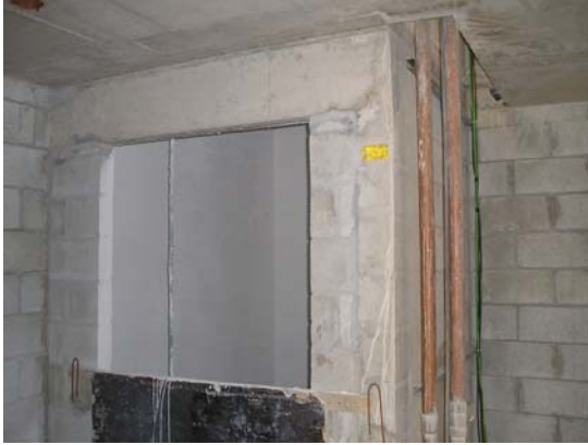
Hall de elevadores com shaft hidr. e elétr.
