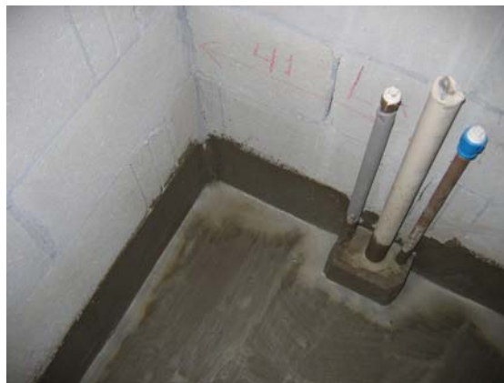
Pontos para lavatório com proteção inferior
