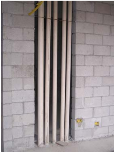
Passagem para prumada hidr.
