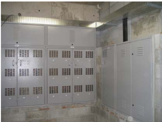
Centro de medição do edifício Green Park
