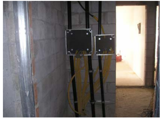
Hall de elevadores, shaft inst. elétricas
