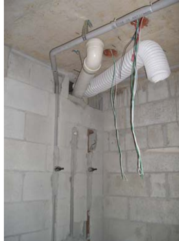
Parede hidráulica de vedação
