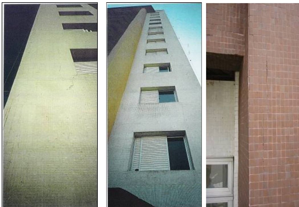
Figuras 17, 18 e 19 : Fissuras presentes nos vértices das janelas e de maneira generalizada em outras áreas.
