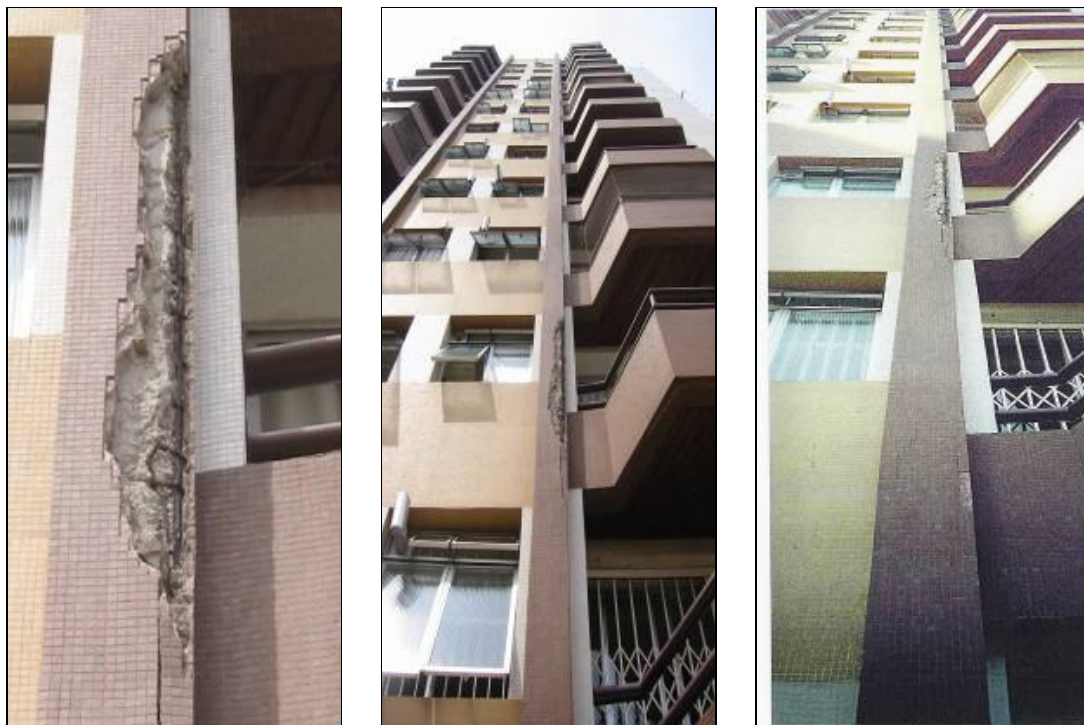
Figuras 14, 15 e 16 : Pilares externos com armaduras corroídas provocando o desprendimento das camadas de revestimento e do emboço.
