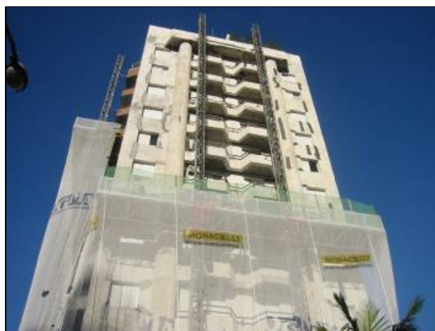
Figura 32 : Telas de proteção instaladas em toda a extensão da plataforma
