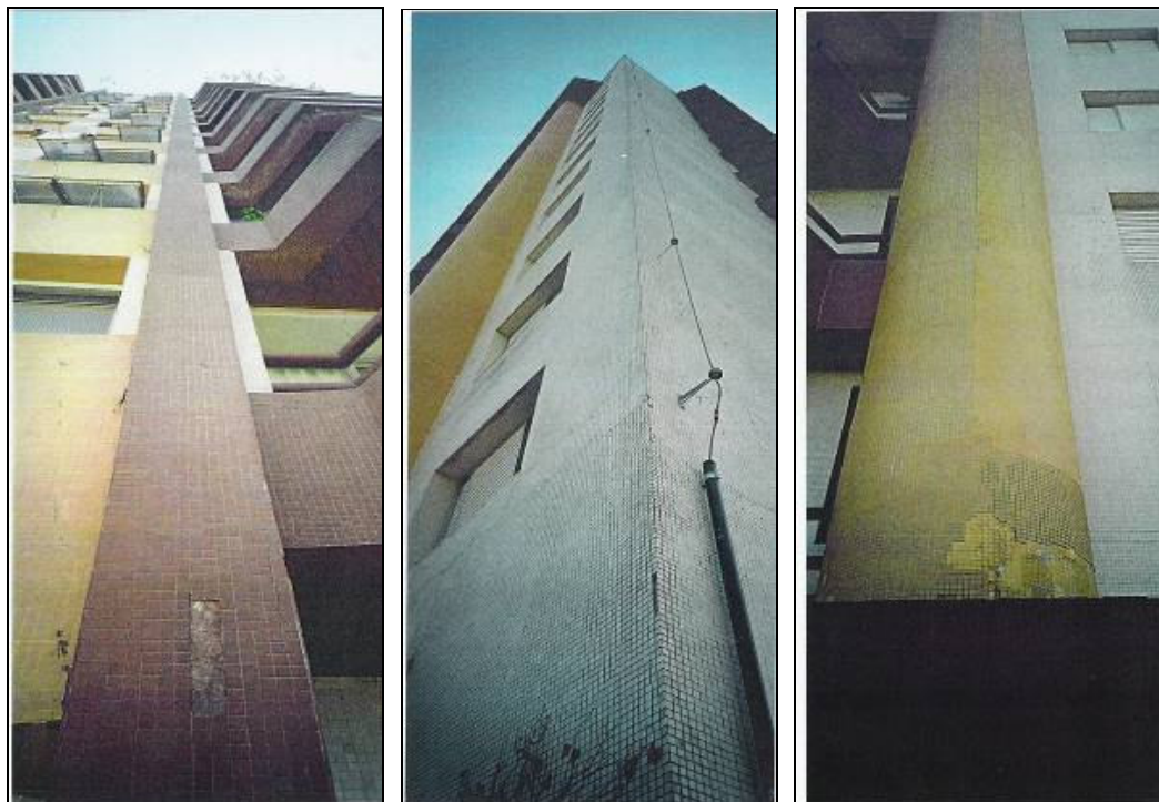
Figuras 8, 9 e 10: Fachadas com desprendimento de pastilhas
