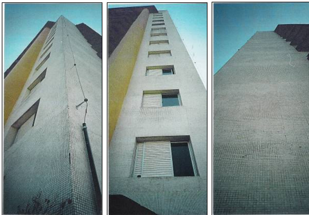
Figuras : 5, 6 e 7: Fachadas apresentando deterioração no rejuntamento das pastilhas
