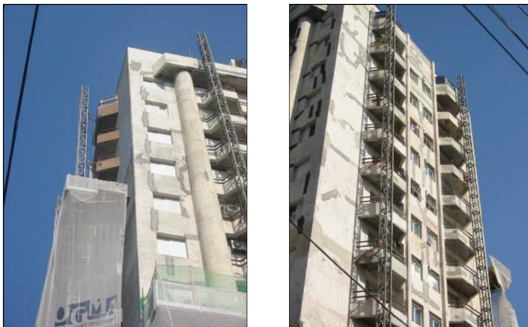
Figuras 52 e 53 : Vista das fachadas principal (NE) e direita (NO) onde pode-se observar as marcas dos tratamentos de fissuras realizados de acordo com o procedimento descrito anteriormente.
