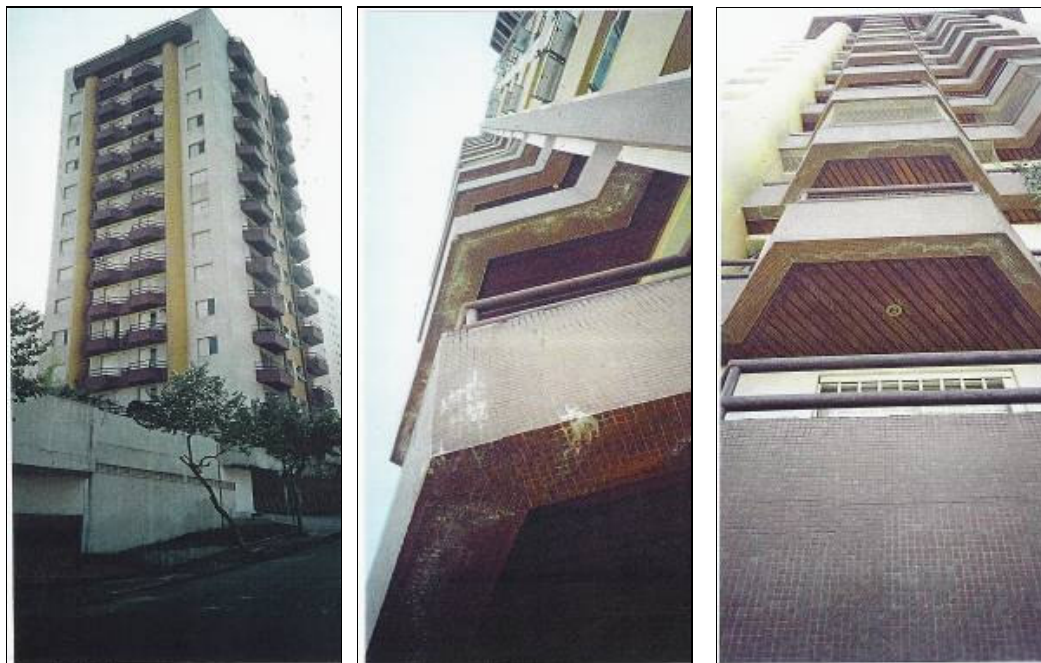
Figuras 20, 21 e 22 : Presença de fantasmas nos panos maiores e eflorescências nas áreas dos terraços.
