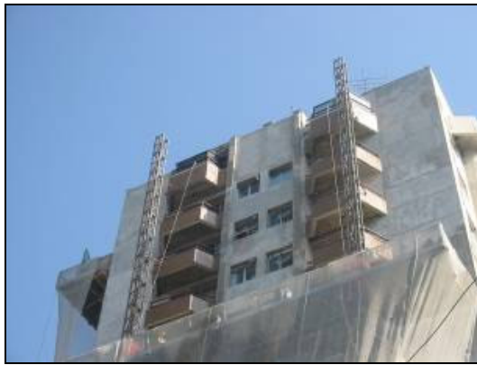
Figura 27 : As plataformas não são sustentadas por cabos presos em vigas metálicas lançadas a partir da cobertura do telhado do edifício.
