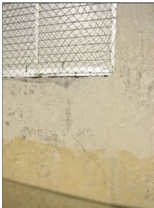
Figura 45 : Marcar a posição da fissura sobre a superfície do emboço até, sempre que possível, ultrapassar seu final em pelo menos 30 cm. Limpar a faixa com uma escova e lavagem, para eliminar resíduos e poeira.
