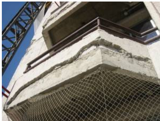
Figura 55 : Espessura do emboço totalmente fora dos padrões
