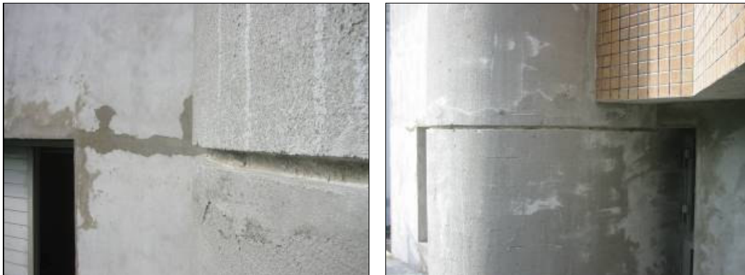
Figura 66 e 67 : Detalhe do sulco criado na altura entre o encunhamento da alvenaria e a estrutura
