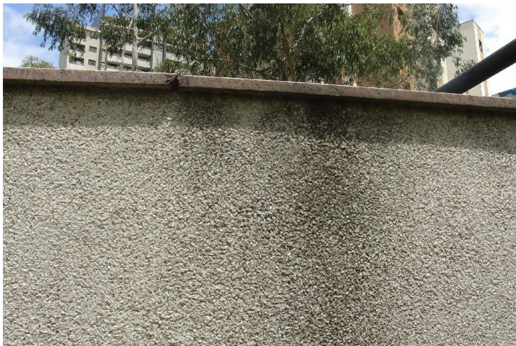
Foto 4.8 – Detalhe 1 das manchas causadas pela pingadeira imprópria
