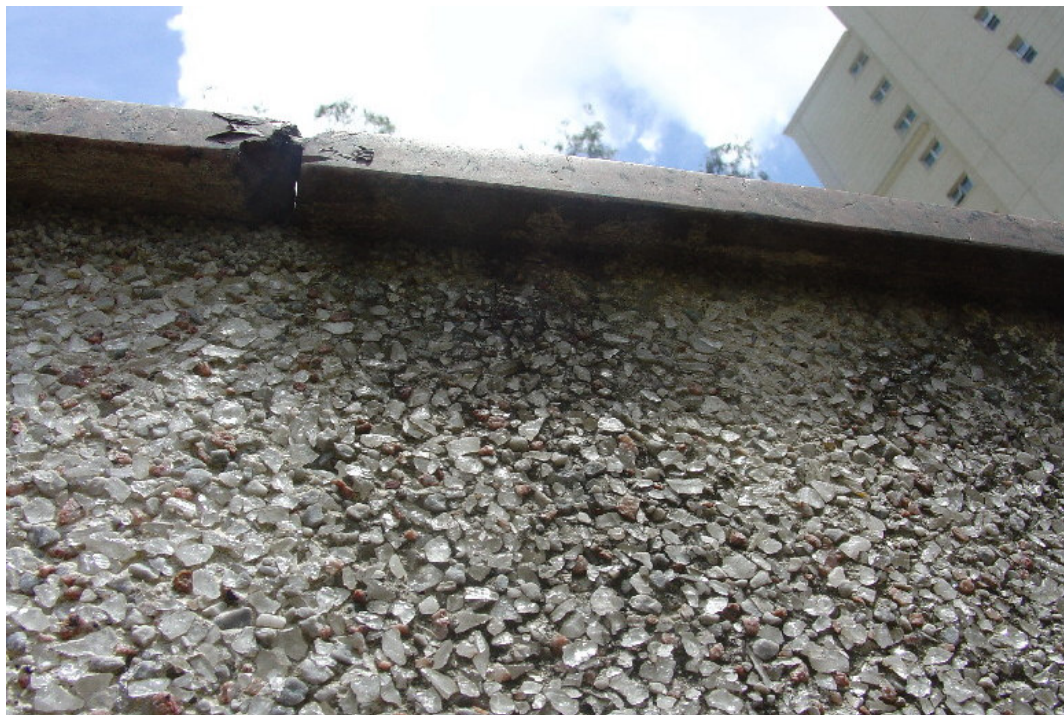
Foto 4.9 – Detalhe 2 das manchas causadas pela pingadeira imprópria
