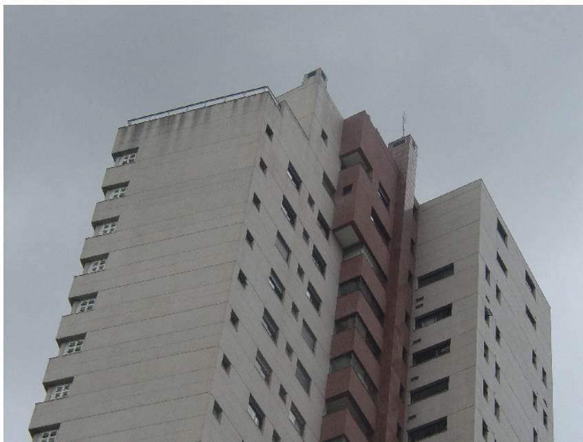
Foto 4.3 – Manchas na parede do ático
