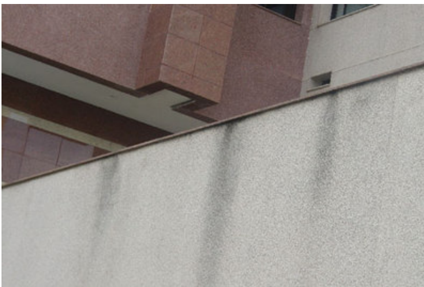
Foto 4.5 - Manchas no muro entre as pedras de granito
