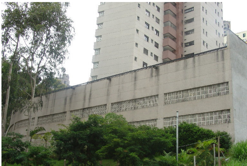
Foto 4.4 - Manchas no muro com pingadeira de granito
