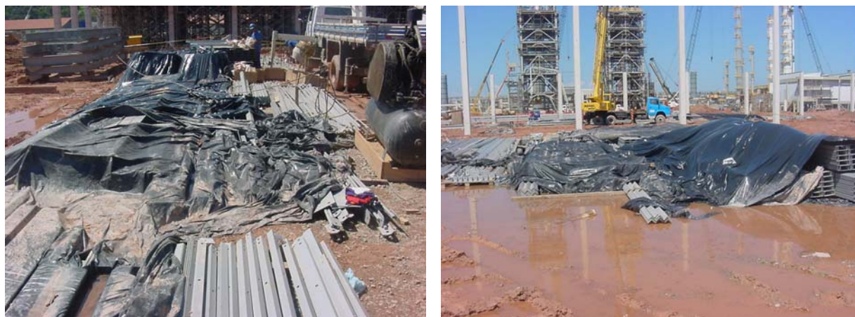
Figuras 26 e 27: Problemas de estocagem de materiais e má proteção dos mesmos
