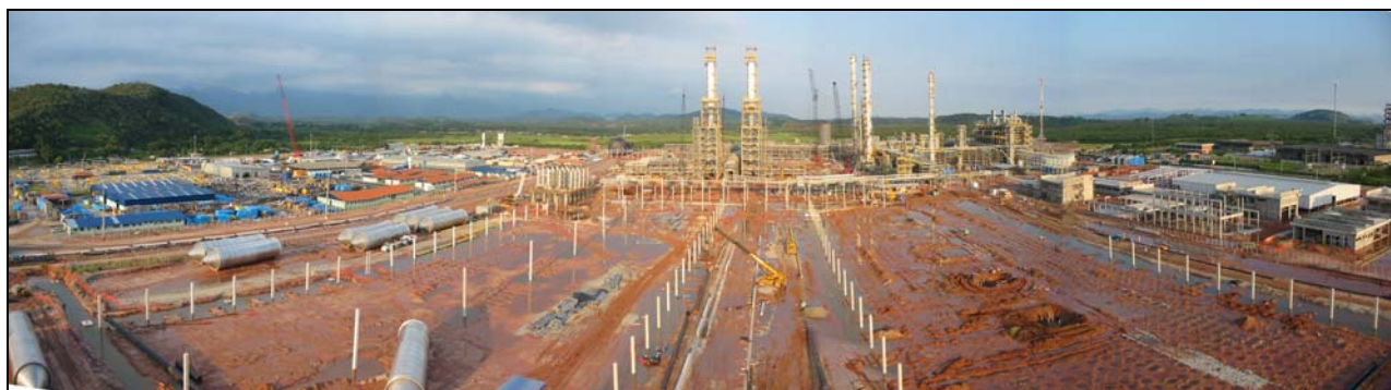
Figura 18: Problemas de circulação na obra ocasionados pelo excesso de chuvas
