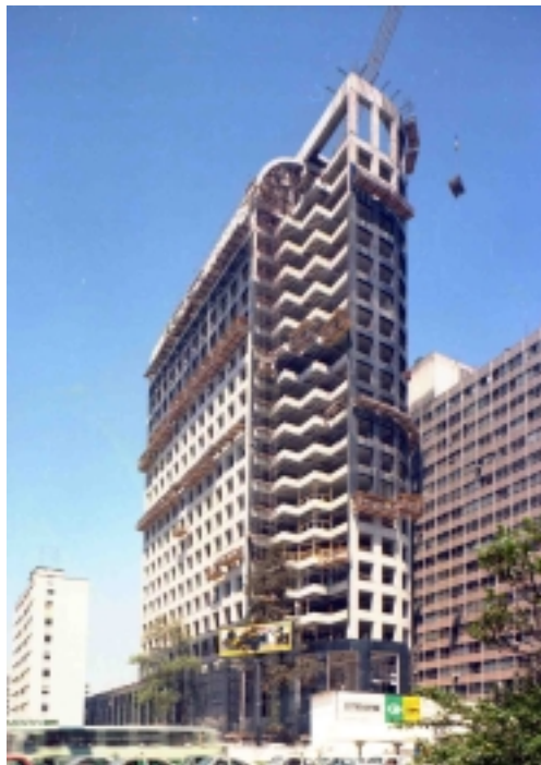
Figura 5.11 - Frentes de vigas da estrutura pintada com uma mistura especial de látex e cola (Fonte: CBPO,1986)
