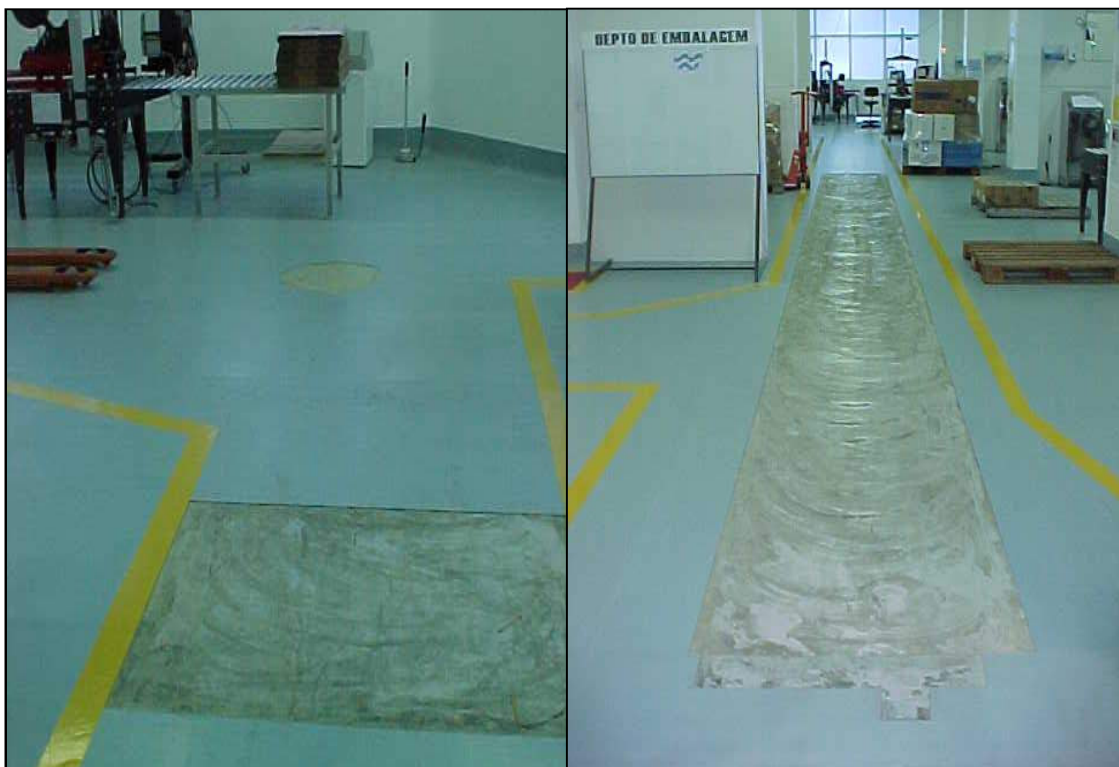
Vistas internas do piso industrial danificado
